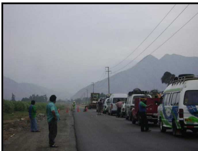
Imagen N°05: Mejoras en las Provincias Trujillo–Sánchez Carrión. Mejoramiento carretera Trujillo – Otuzco. (05 de Febrero 2011).
