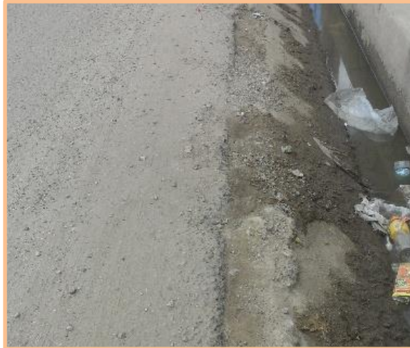
Foto 9. Fisuras Longitudinales y Transversales
