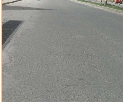
Severidad baja U40
