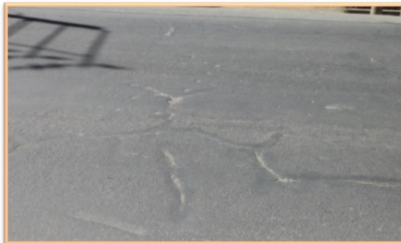
Fotografía. 02: Deformación longitudinal de la Vía de Evitamiento Norte cuadra 8.
