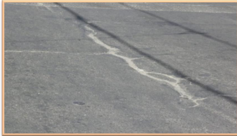
Fotografía. 01: Deformación longitudinal de la Vía de Evitamiento Norte cuadra 5
