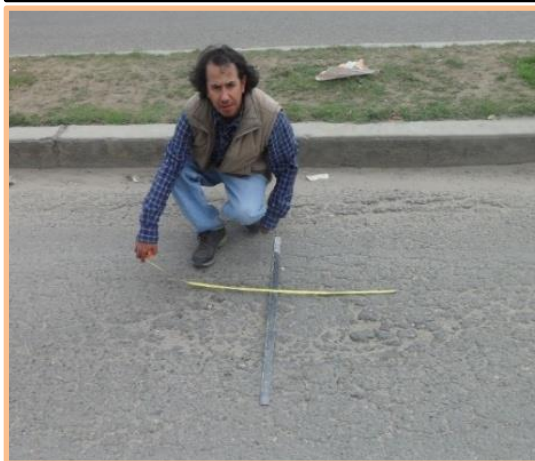
Falla de bache
