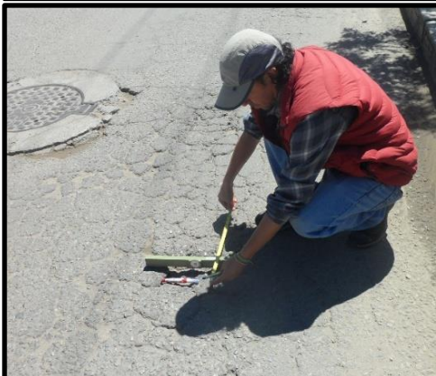
Falla piel de cocodrilo
