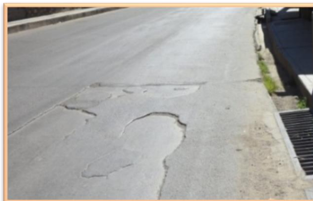
Fotografía 05: Desprendimientos-desintegración superficial, (peladuras, baches, desmoronamientos, rotura de bordes, parches).
