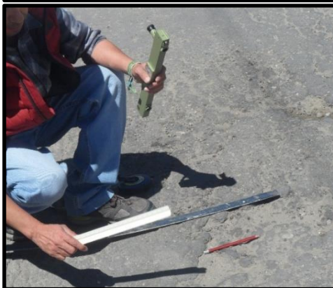
Fisuras en bloque
