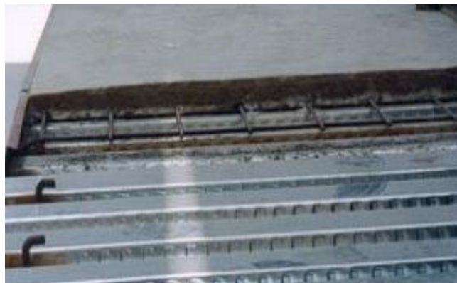
Figura 17. Entrepiso metálico con láminas colaborantes.
