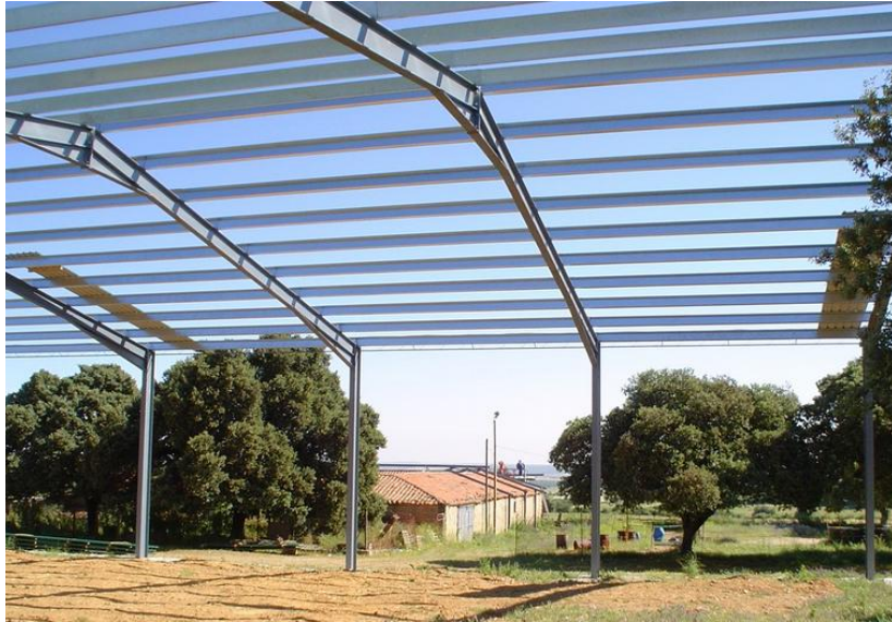
Figura 13. Uso de perfil C para las correas de la cubierta de una estructura metálica.
