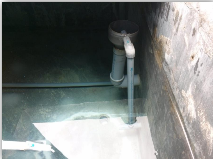
Foto 03: Nivel estático en el reservorio de 3 m 3
