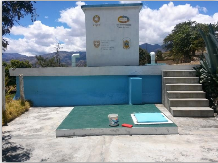
Foto 03: Reservorio de 96m 3
