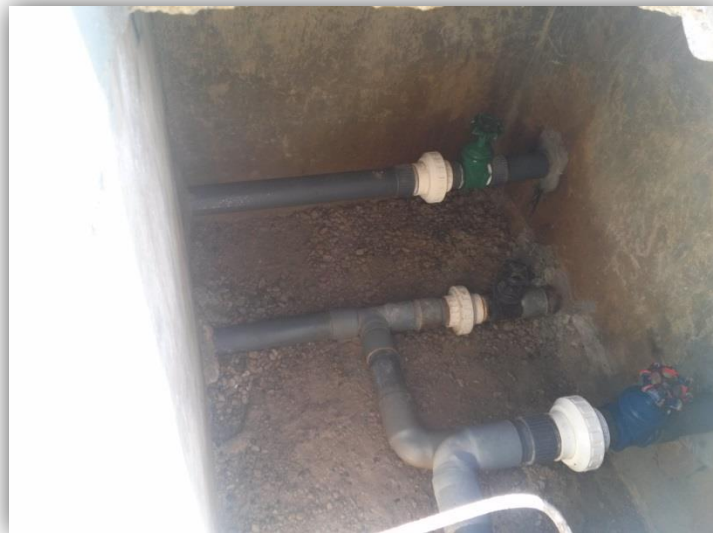
Foto 05: Válvulas del reservorio de 96 m3
