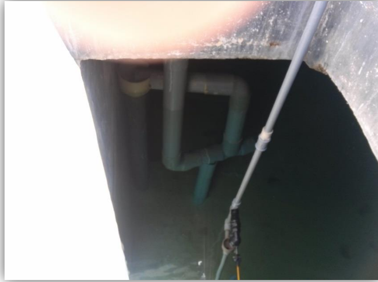
Foto 04: Nivel estático en el reservorio de 96 m3
