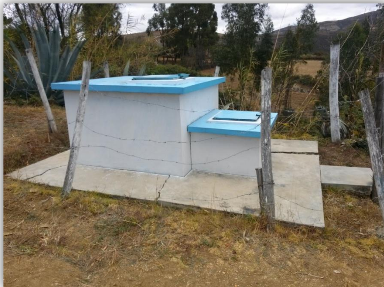
Foto 02: Reservorio de 3m3
