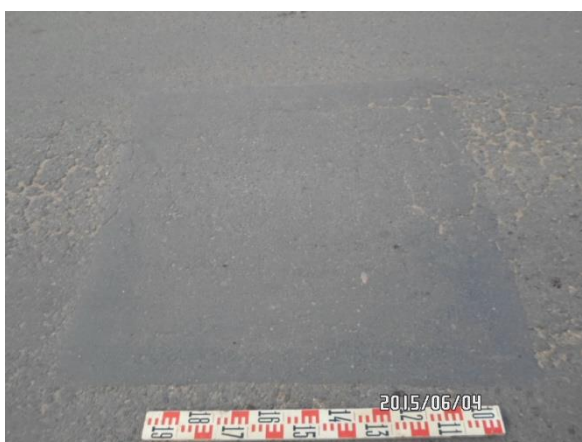
Foto 79. Parche (PCH) de severidad baja.
