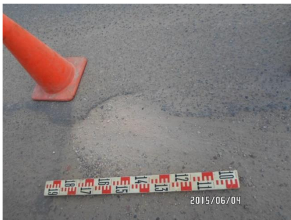
Foto 25. Hundimiento (HUN) de severidad media, dimensión apreciable.
