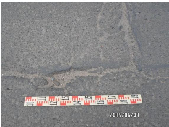
Foto 53. Hundimiento (HUN) de severidad media junto a grietas.
