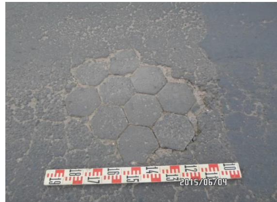
Foto 76. Parche (PCH) de severidad media con bloques de concreto.
