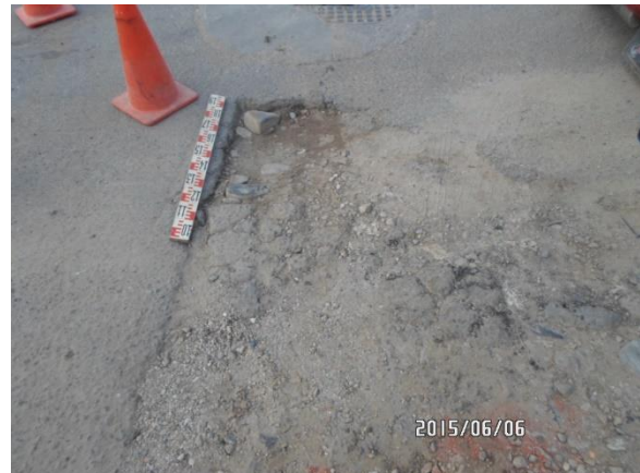
Foto 148. Parche (PCH) de severidad alta.
