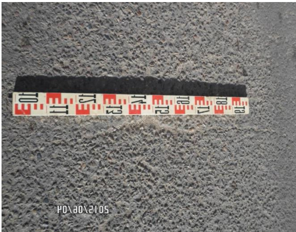
Foto 69. Desgaste superficial (DSU) con severidad media.
