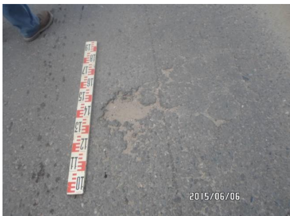
Foto 107. Hundimiento (HUN) de severidad baja.
