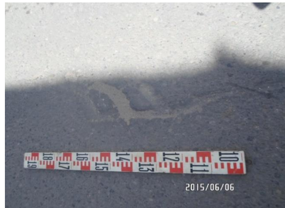
Foto 106. Hundimiento (HUN) de severidad baja.
