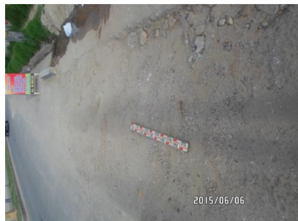
Foto 132. Hundimiento (HUN) de severidad alta.
