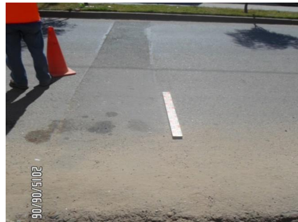
Foto 112. parche (PCH) de severidad baja.
