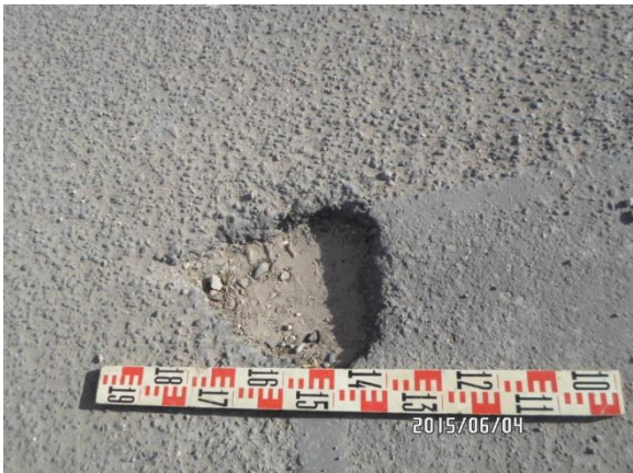
Foto 57. Bache (BCH) de severidad alta, ocasiona malestar a los usuarios.
