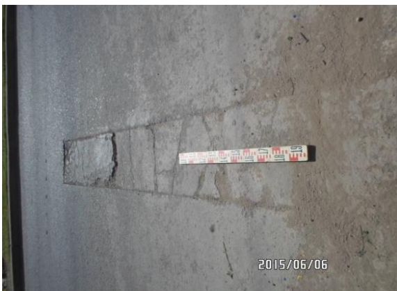
Foto 91. Parche (PCH) de severidad media.
