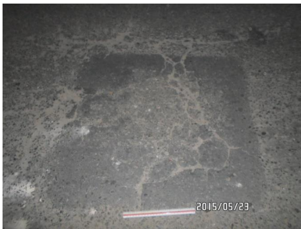
Foto 05. Parche (PCH) de severidad media con una fisura transversal.
