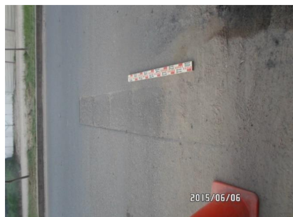
Foto 134. Parche (PCH) de severidad media.
