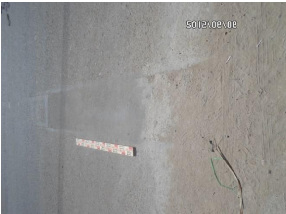
Foto 111. Parche (PCH) de severidad baja.
