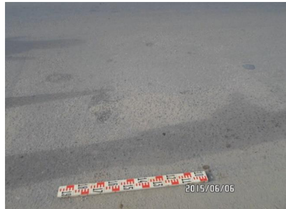
Foto 126. Parche (PCH) de severidad baja.
