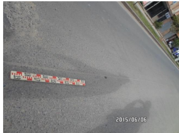
Foto 124. Fisura longitudinal (FL) de severidad baja.
