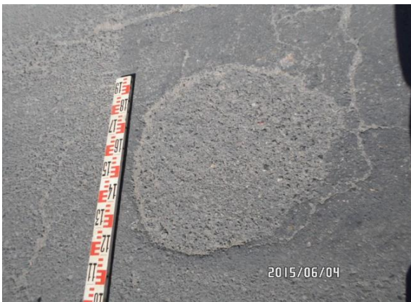
Foto 41. Parche (PCH) de severidad media
