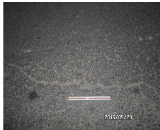
Foto 04. Falla de fisura longitudinal de severidad alta con abertura > 3mm
