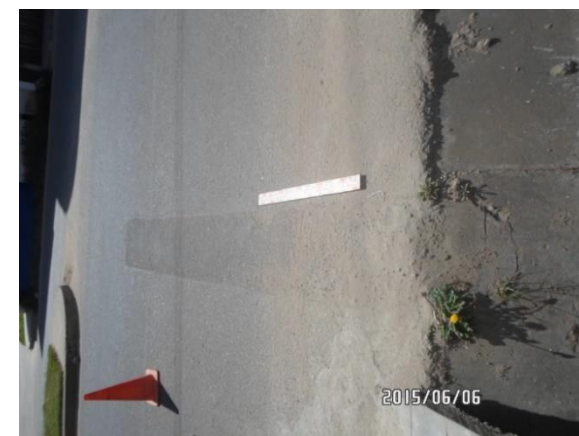
Foto 104. Parche (PCH) de severidad baja.
