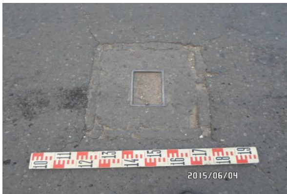
Foto 83. Parche (PCH) de severidad media, caja de agua.
