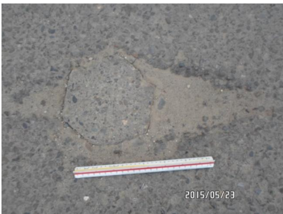
Foto 11. Parche PCH de severidad baja con bloque de concreto.
