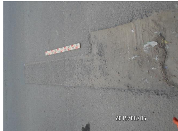
Foto 142. Parche (PCH) de severidad media.
