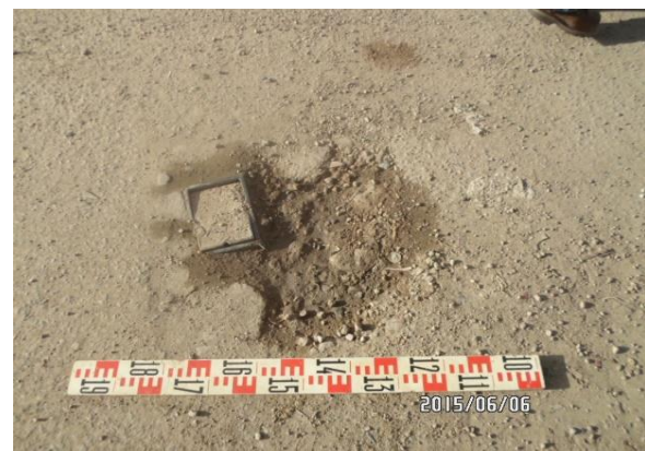
Foto 122. Parche (PCH) de severidad alta.
