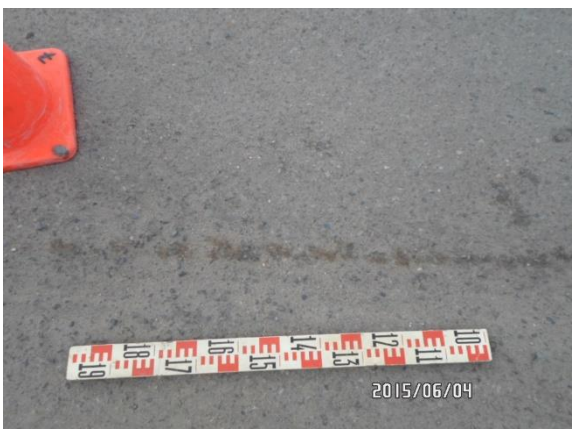
Foto 55. Fisura longitudinal (FL) de severidad baja.
