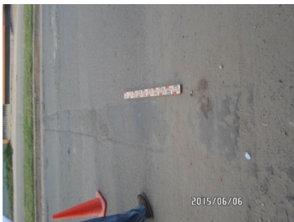
Foto 139. Parche (PCH) de severidad baja.
