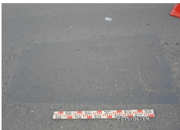
Foto 85. Parche (PCH) de severidad baja
