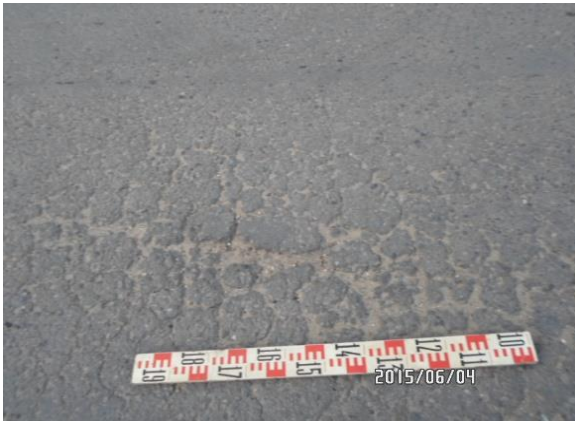
Foto 93. Piel de cocodrilo (PC) de severidad alta.
