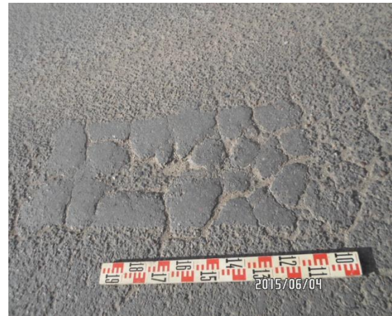
Foto 70. Parche (PCH) con severidad alta.
