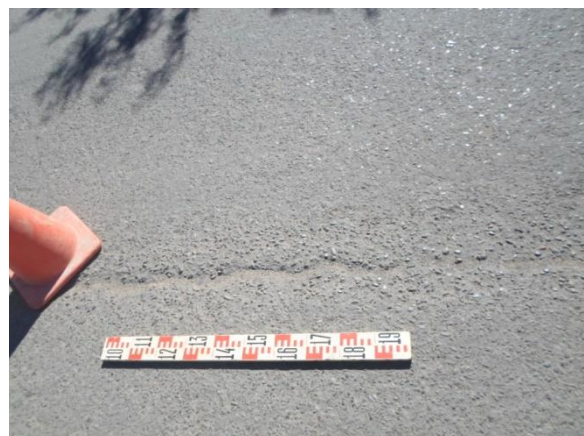
Foto 50. Fisura longitudinal (FL) de severidad alta y de abertura > 3 mm.
