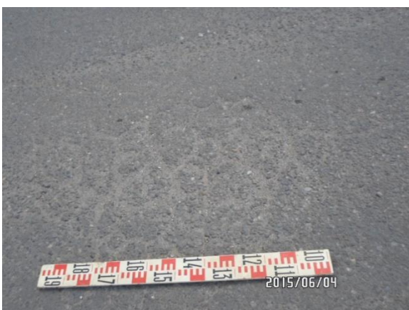
Foto 43. Piel de cocodrilo (PC) de severidad media
