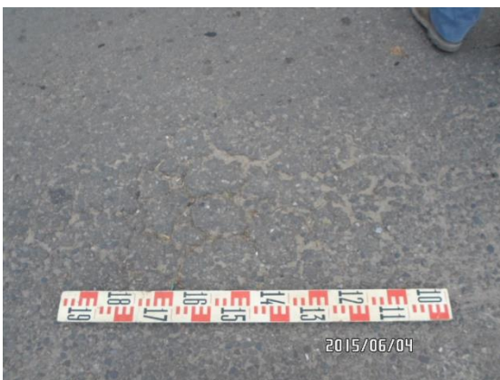
Foto 73. Piel de cocodrilo (PC) de severidad baja.
