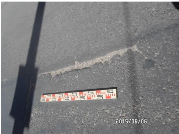
Foto 101. Hundimiento (HUN) de severidad media
