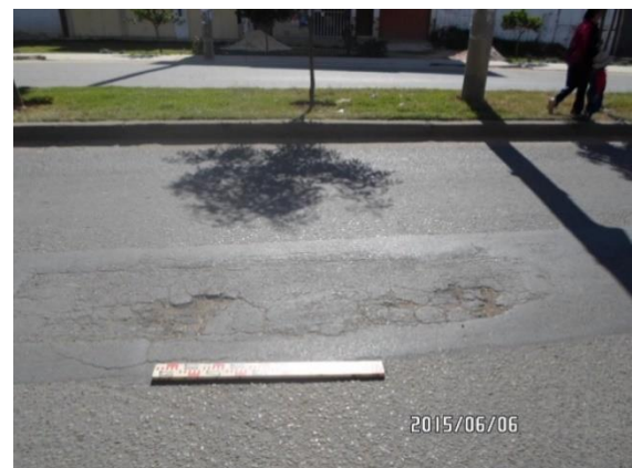
Foto 98. Parche (PCH) de severidad media.
