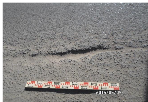
Foto 30. Fisura longitudinal (FL) de severidad alta con apreciable profundidad.
