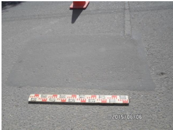
Foto 105. Parche (PCH) de severidad baja.
