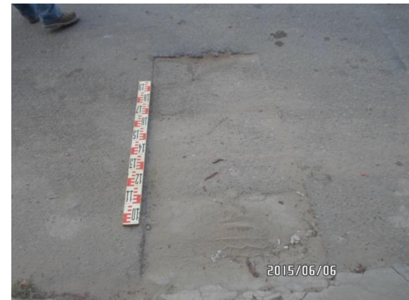
Foto 144. Parche (PCH) de severidad alta.
