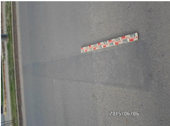
Foto 125. Parche (PCH) de severidad baja
