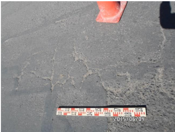
Foto 51. Parche (PCH) de severidad baja junto a fisuras.
