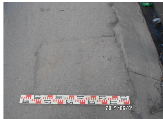
Foto 72. Parche (PCH) de severidad media con fisuras.
