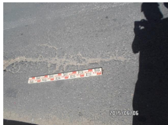
Foto 108. Hundimiento HUN de severidad media.
