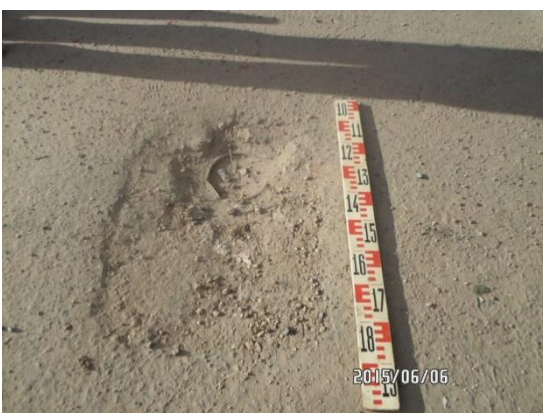
Foto 121. Hundimiento (HUN) de severidad media
