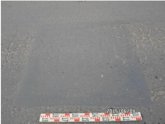
Foto 87. Parche (PCH) de severidad baja.
