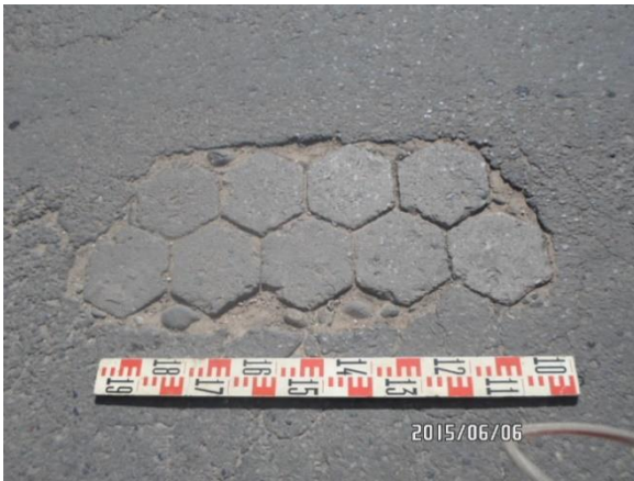
Foto 99. Parche (PCH) de severidad baja con bloques de concreto.
