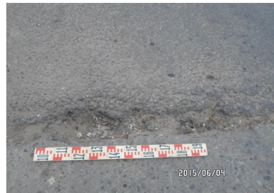
Foto 84. Hundimiento (HUN) de severidad alta
