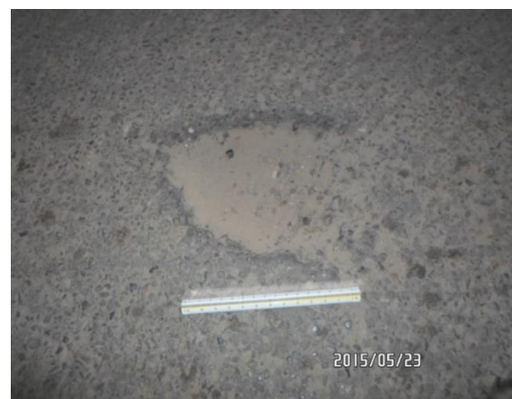
Foto 08. Bache (BCH) de severidad alta, llegando a la base del pavimento.
