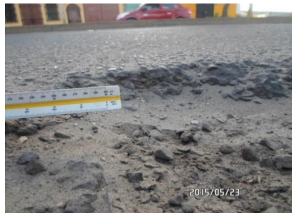
Foto 10. Bache BCH de severidad alta donde ya paso la carpeta asfáltica hasta la base.
