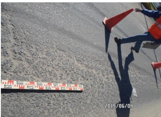
Foto 31. Piel de cocodrilo (PC) de severidad alta
