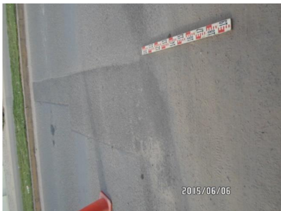
Foto 137. Parche (PCH) de severidad baja.
