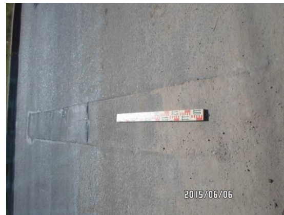
Foto 90. Parche (PCH) de severidad baja. Con un leve hundimiento
