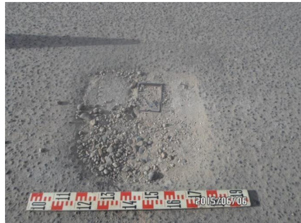
Foto 118. Parche (PCH) de severidad alta.
