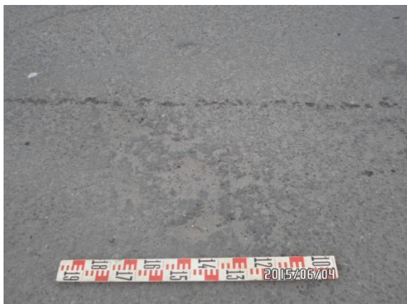
Foto 77. Hundimiento (HUN) de severidad baja.
