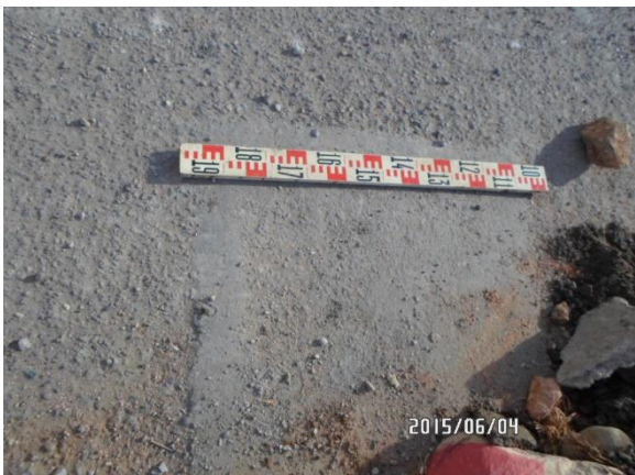
Foto 59. Parche (PCH) de severidad baja de material asfáltico.
