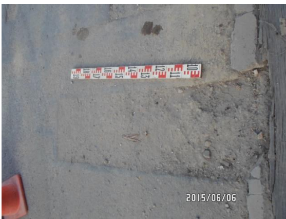
Foto 143. Parche (PCH) de severidad alta.
