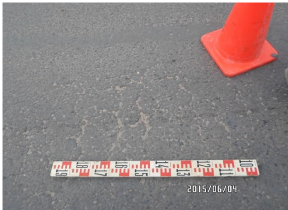
Foto 75. Piel de cocodrilo (PC) de severidad media.
