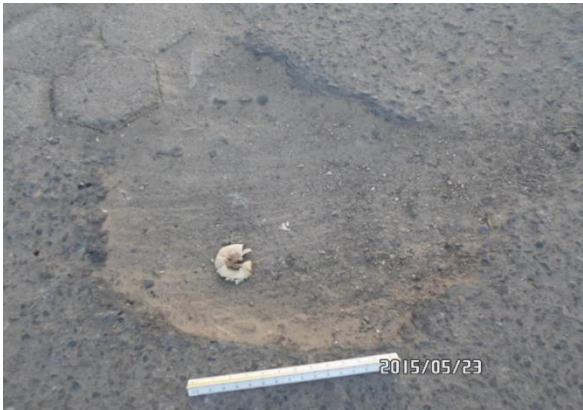
Foto 15. Bache (BCH) de severidad alta, ocasiona mal servicio de la vía.
