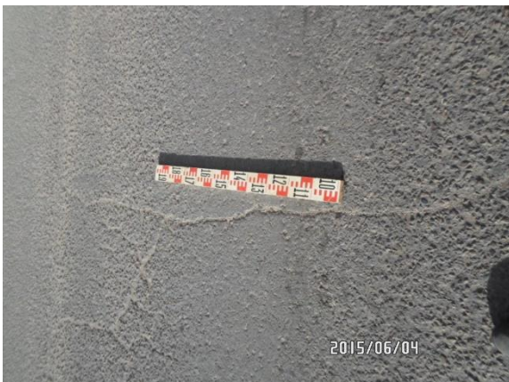
Foto 67. Fisura longitudinal FL de severidad media con abertura entre 1-3 mm
