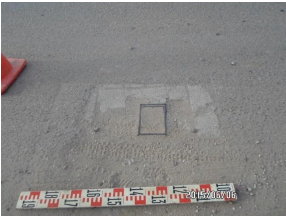
Foto 129. Parche (PCH) de severidad media.
