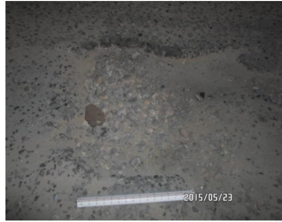
Foto 06. Bache (BCH) de severidad alta que afecta al tránsito normal.
