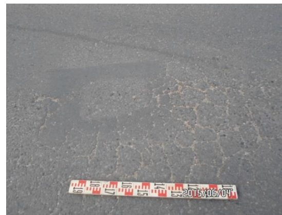
Foto 92. Piel de cocodrilo (PC) de severidad baja.
