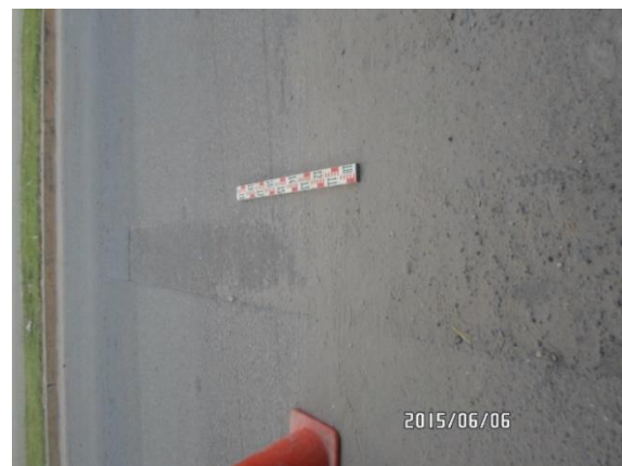
Foto 138. Parche (PCH) de severidad baja.
