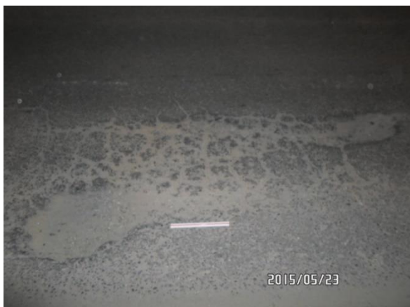
Foto 01. Conjunto de fallas entre piel de cocodrilo y baches de severidad alta
