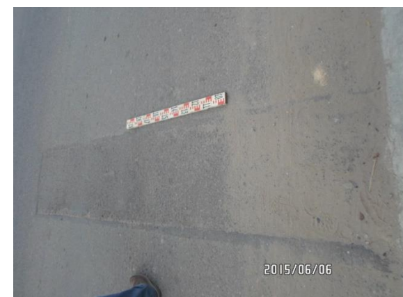
Foto 146. Parche (PCH) de severidad baja.
