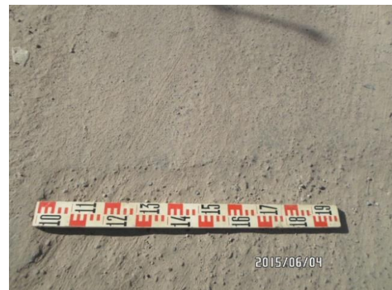
Foto 26. Hundimiento (HUN) de severidad baja
