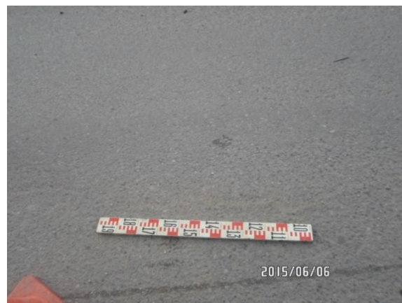
Foto 140. Piel de cocodrilo (PC) de severidad baja.
