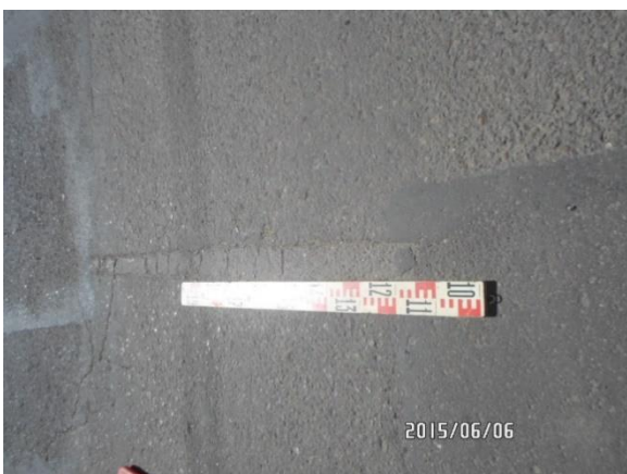
Foto 103. Parche (PCH) de severidad baja.
