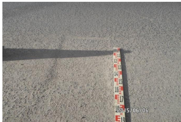
Foto 120. Parche (PCH) de severidad baja.
