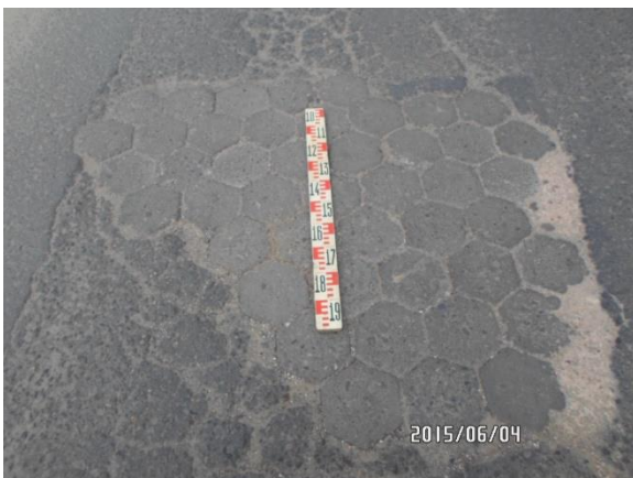
Foto 47. Parche (PCH) de severidad baja, pero de gran extensión.
