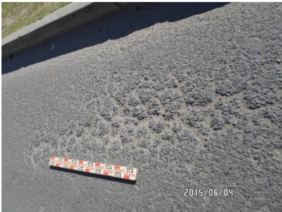
Foto 35. Piel de cocodrilo (PC) de severidad alta con fisuras pronunciadas.
