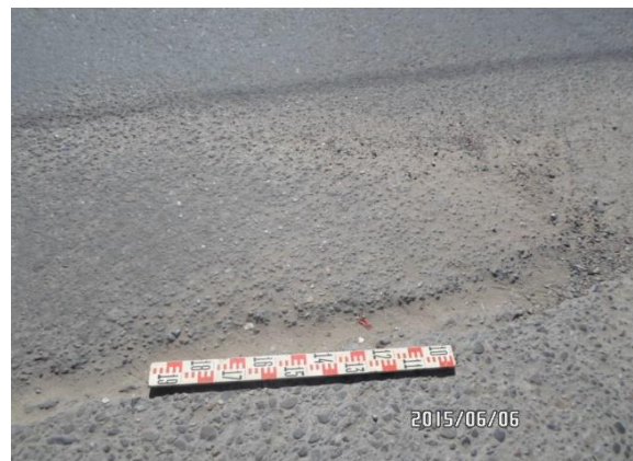
Foto 96. Hundimiento (HUN) de severidad alta.
