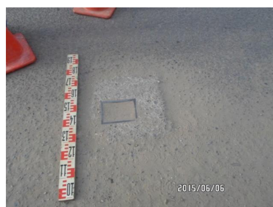
Foto 128. Parche (PCH) de severidad media.
