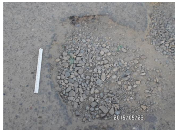
Foto 20. Bache (BCH) de severidad alta con una profundidad > 50 mm.
