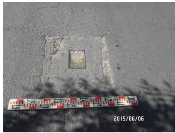
Foto 100. Parche (PCH) de severidad baja.
