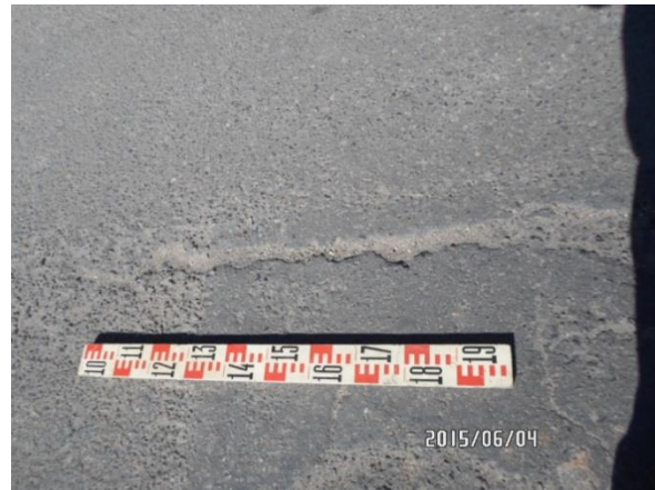
Foto 46. Fisura longitudinal (FL) de severidad alta con una gran profundidad.
