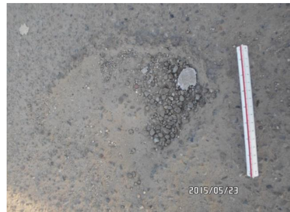
Foto 18. Bache (BCH) de severidad alta que afecta al tráfico.
