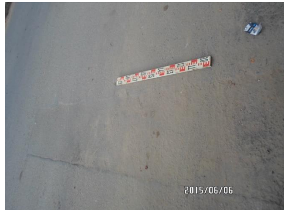
Foto 130. Parche (PCH) de severidad baja.
