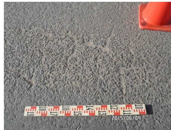
Foto 62. Piel de cocodrilo (PC) de severidad media con desgaste borde.
