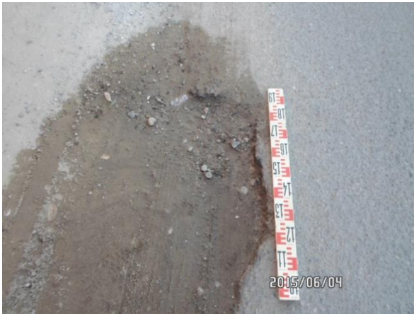
Foto 39. Hundimiento (HUN) de severidad alta sobre la carpeta asfáltica.
