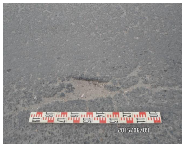
Foto 66. Hundimiento HUN de severidad media con profundidad entre 20-40 mm.
