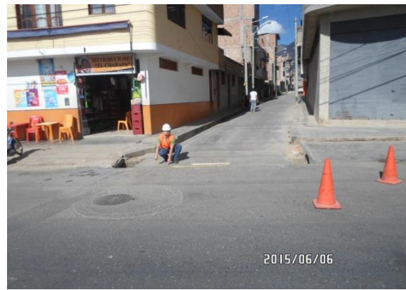
Foto 94. Momento de la medición de las fallas.
