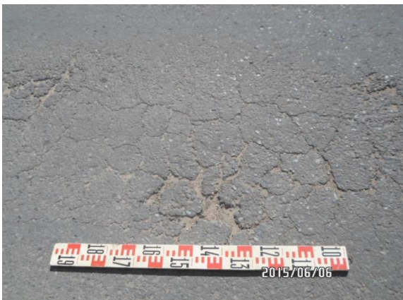
Foto 95. Hundimiento (HUN) de severidad media con fisuras.
