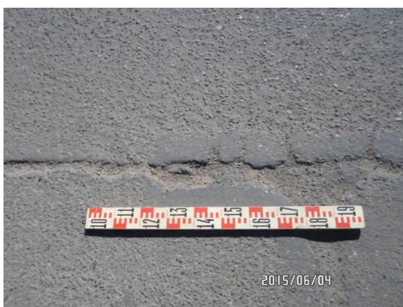
Foto 44. Fisura longitudinal (FL) de severidad alta con abertura > de 3 mm.
