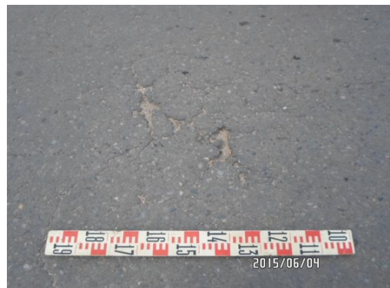
Foto 86. Hundimiento (HUN) de severidad baja.
