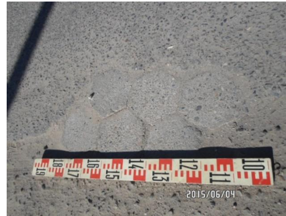
Foto 34. Parche (PCH) de severidad baja con bloques de concreto.
