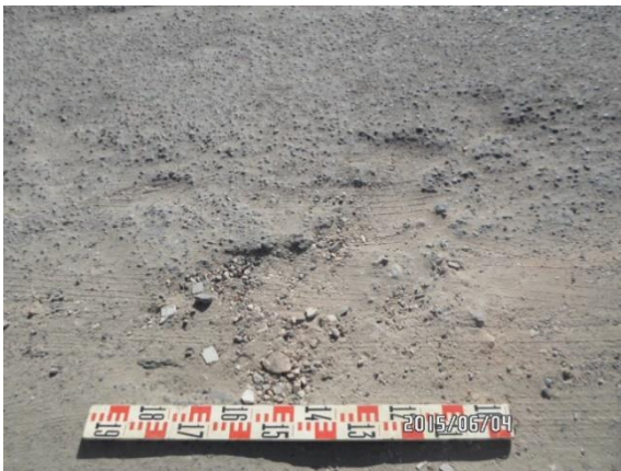
Foto 27. Hundimiento (HUN) con severidad media que si afecta al tráfico.
