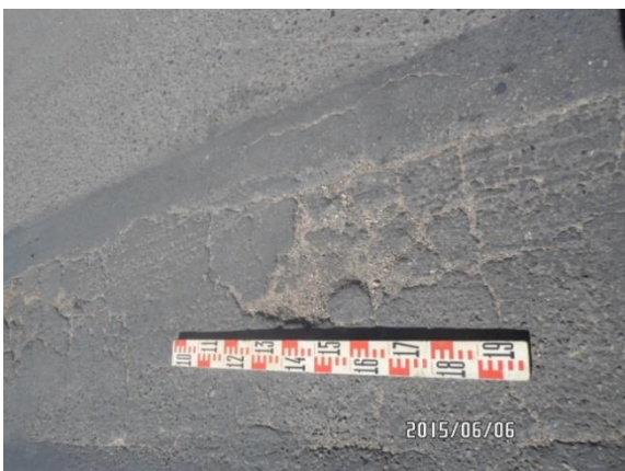
Foto 97. Hundimiento (HUN) de severidad media.
