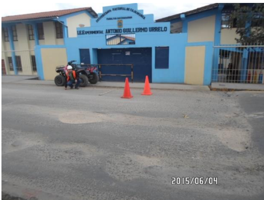
Foto 71. Bache (BCH) de severidad alta al frente del colegio Urrelo.
