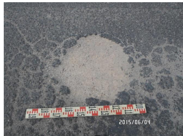
Foto 48. Hundimiento (HUN) de severidad media con una profundidad entre 20-40 mm.
