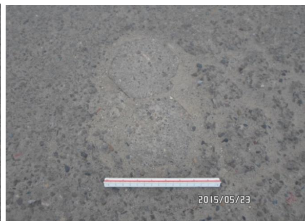
Foto 12. Parche PCH de severidad baja con bloques de concreto.
