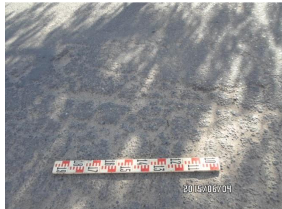
Foto 24. Piel de cocodrilo (PC) de severidad alta con fisuras pronunciadas.
