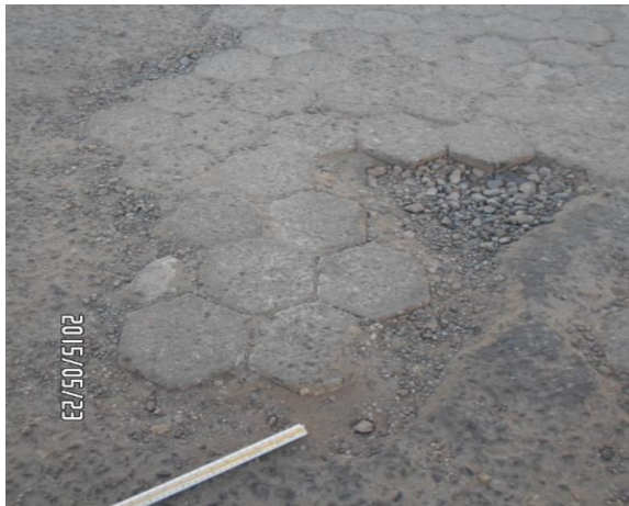
Foto 21. Parche (PCH) de severidad media con bloques de concreto.
