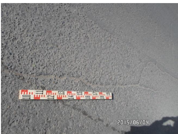
Foto 61. Fisura longitudinal (FL) de severidad alta con abertura > 3 mm
