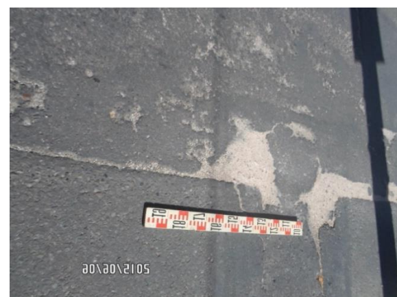
Foto 102. Parche (PCH) de severidad baja.
