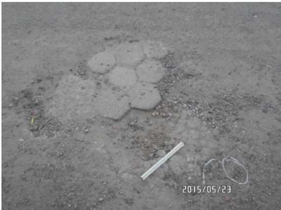
Foto 09. Parche PCH de severidad media con bloques de concreto.
