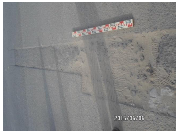
Foto 136. Parche (PCH) de severidad media.
