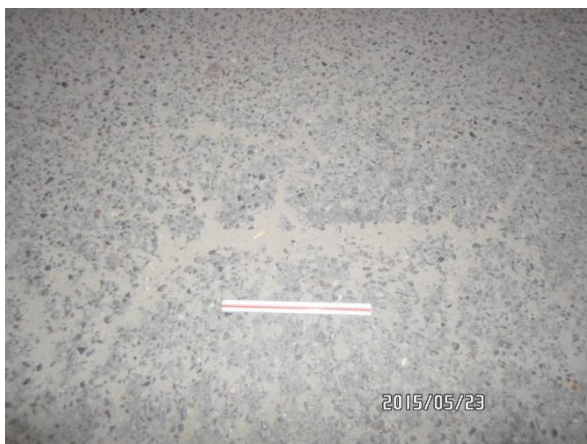
Foto 07. Fisura longitudinal (FL) con severidad media, no afecta significativamente a los vehículos pero puede evolucionar a una falla más
