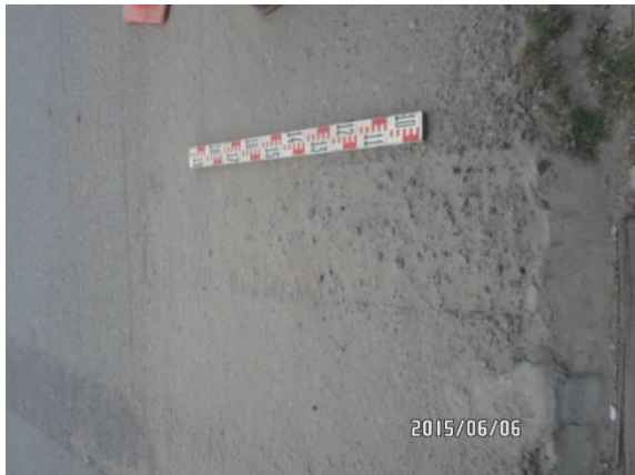
Foto 135. Parche (PCH) de severidad media.
