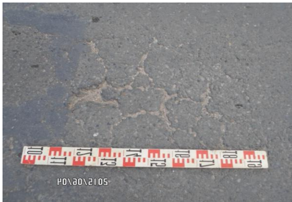
Foto 81. Piel de cocodrilo (PC) de severidad media.
