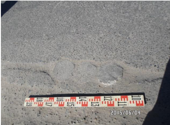
Foto 33. Parche (PCH) de severidad baja con bloques de concreto.
