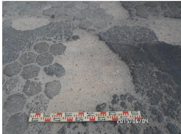
Foto 54. Parche con hundimiento de severidades altas y q afectan al tráfico.
