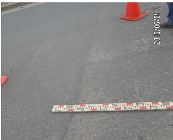
Foto 65. Parche (PCH) de severidad baja. Conexión de desagüe.
