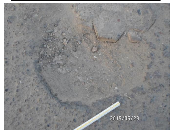
Foto 14. Bache (BCH) de severidad alta, ocasiona mal servicio de la vía.
