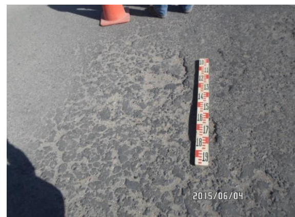
Foto 42. Parche (PCH) de severidad alta que afecta ya al tráfico.
