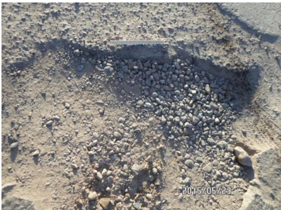
Foto 19. Bache (BCH) de severidad alta de gran dimensión.
