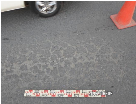
Foto 45. Piel de cocodrilo (PC) de severidad media con fisuras no tan pronunciadas
