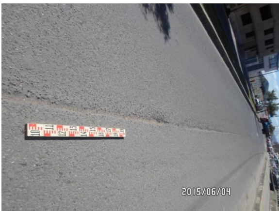
Foto 49. Fisura longitudinal (FL) de severidad media y de extensa
