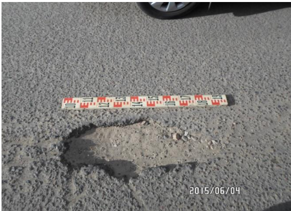
Foto 63. Bache (BCH) de severidad alta con profundidad > 50 mm
