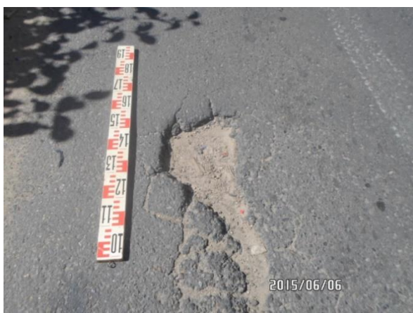
Foto 109. Hundimiento (HUN) de severidad alta.
