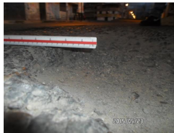
Foto 02. Se aprecia la gran profundidad que presenta la falla de bache >50 mm
