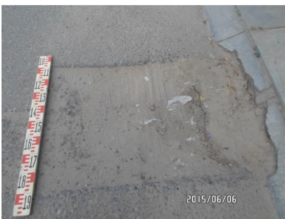
Foto 145. Parche (PCH) de severidad media.
