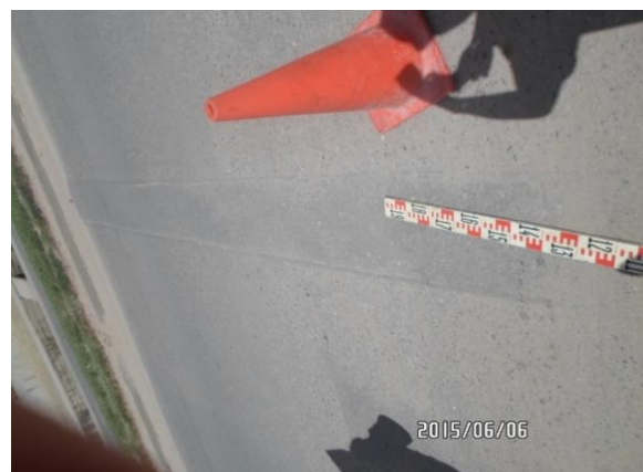
Foto 116. Parche (PCH) de severidad baja.
