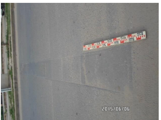
Foto 127. Parche (PCH) de severidad baja.
