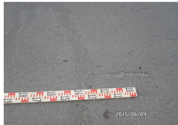
Foto 82. Fisura longitudinal (FL) de severidad baja
