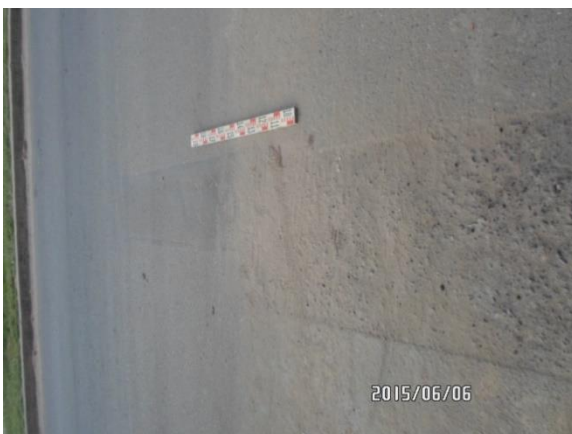
Foto 131. Parche (PCH) de severidad baja.
