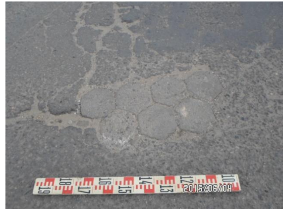
Foto 64. Parche (PCH) con severidad media presenta algunas fisuras
