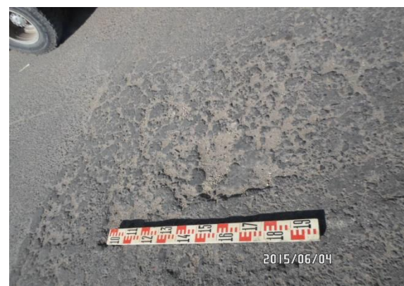
Foto 32. Piel de cocodrilo (PC) de severidad alta.
