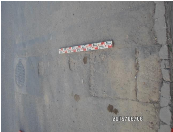
Foto 147. Parche (PCH) de severidad media.
