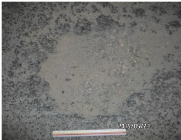
Foto 03. Falla de hundimiento (HUN) con severidad alta.
