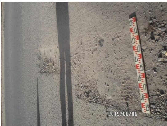
Foto 119. Parche (PCH) de severidad alta.
