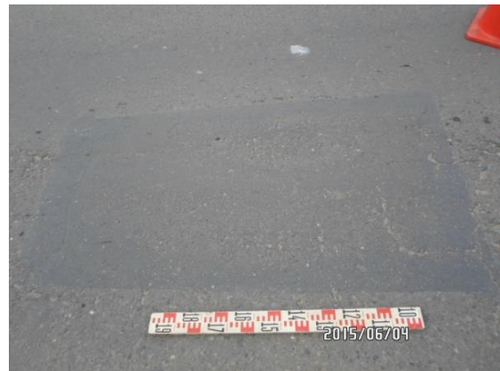
Foto 88. Parche (PCH) de severidad baja.
