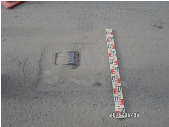
Foto 123. Parche (PCH) de severidad media.
