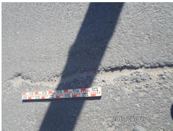
Foto 23. Fisura longitudinal (FL) de severidad alta con abertura > 3mm.
