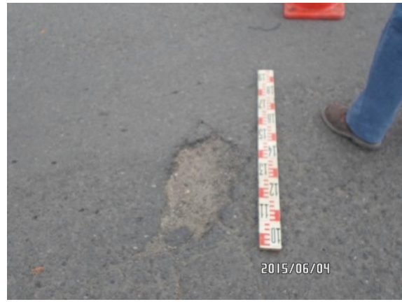
Foto 58. Bache (BCH) de severidad baja, con profundidad < 25 mm.
