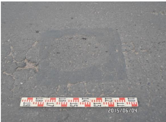
Foto 89. Parche (PCH) de severidad baja.
