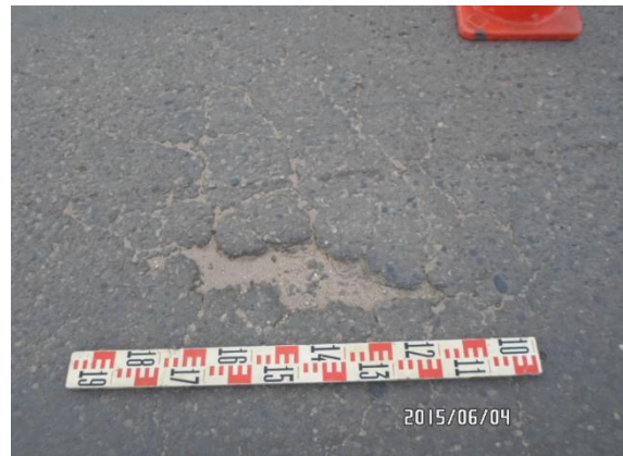
Foto 74. Hundimiento (HUN) de severidad media.
