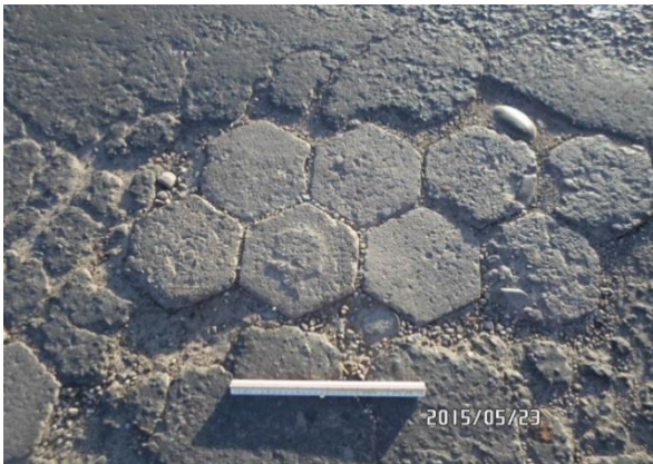
Foto 17. Parche (PCH) de severidad alta con bloques de concreto
