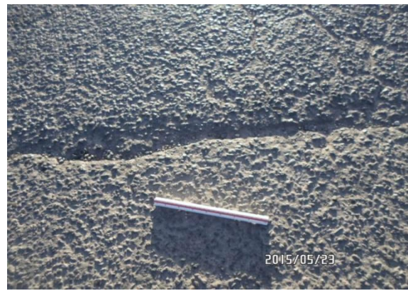
Foto 16. Fisura longitudinal (FL) de severidad alta con abertura > 3mm.
