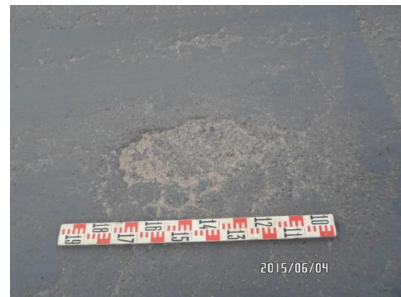
Foto 78. Hundimiento (HUN) de severidad media.
