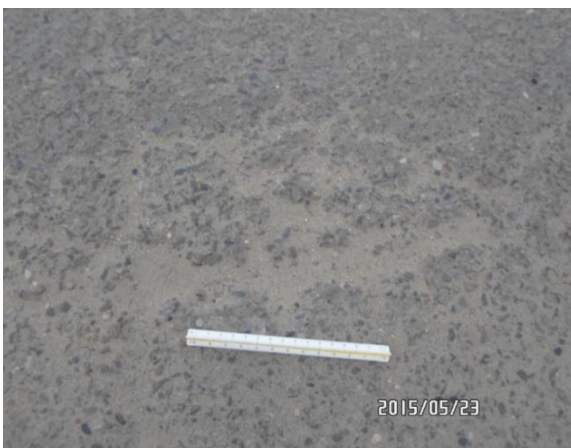
Foto 13. Hundimiento HUN que no afecta al tráfico.
