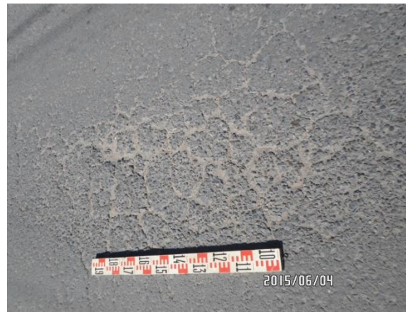
Foto 40. Piel de cocodrilo (PC) de severidad alta con fisuras pronunciadas.
