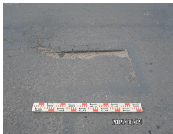
Foto 80. Hundimiento HUN de severidad media con profundidad entre 20-40 mm
