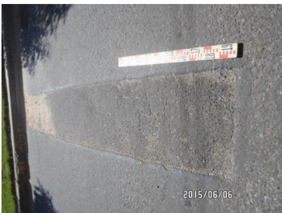
Foto 115. Parche (PCH) de severidad alta.
