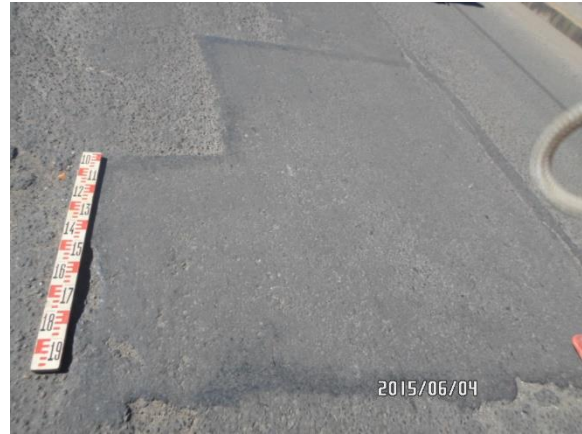
Foto 52. Parche (PCH) de severidad baja con área de afectación.
