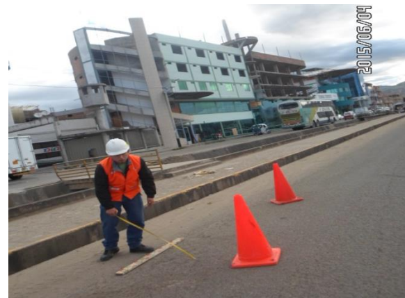
Foto 56. Descascaramiento (DC) en tramo frente a terminal Dias.
