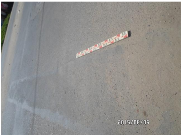
Foto 113. Parche (PCH) de severidad baja.
