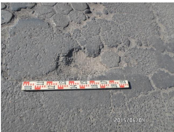
Foto 37. Parche (PCH) de severidad alta con fisuras pronunciadas. Y hundimiento (HUN) alto
