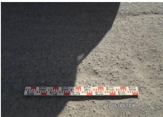
Foto 29. Hundimiento (HUN) de severidad baja en el tramo CDR 3
