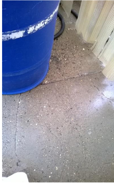
Figura 10: piso de planta sin resanar
