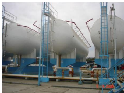
Figura N°05: Tanque de almacenamiento GLP
