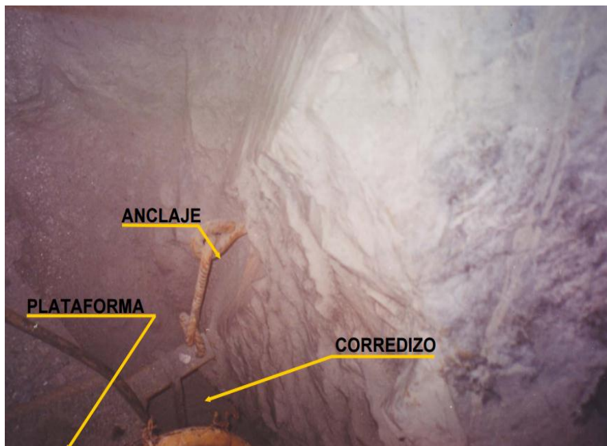
Foto N° 14 Anclaje, Plataforma y Corredizo en una chimenea PEM, Minera Troy.
