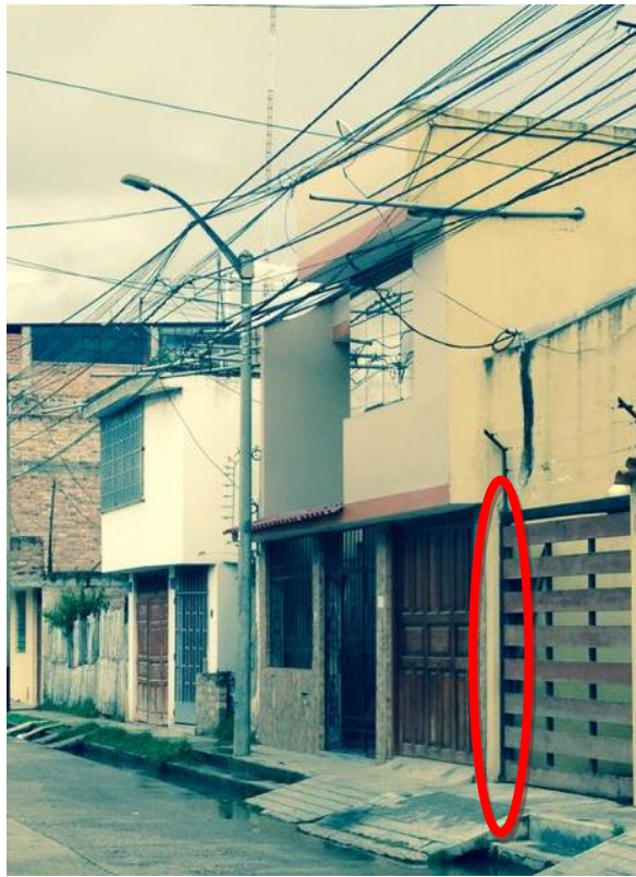
FIGURA N° 5.12 No presenta junta sísmica a los lados
