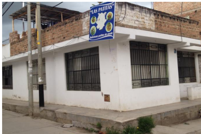
FIGURA N° 6.2.1 Parapeto no arriostrada
