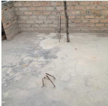
FIGURA N° 6.3 Acero de refuerzo corroído en columna
