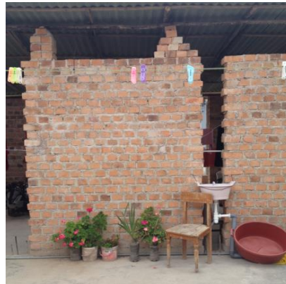
FIGURA N° 6.2 Vivienda con tabiquería no arriostrada
