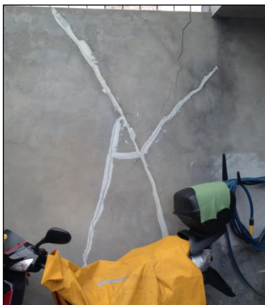
FIGURA N° 6 Fisura por asentamiento en vivienda sobre suelo arcilloso
