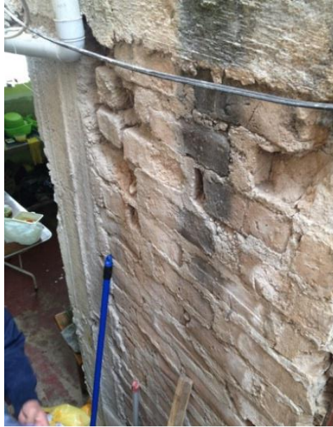
FIGURA N° 6.4 Calidad de construcción mala
