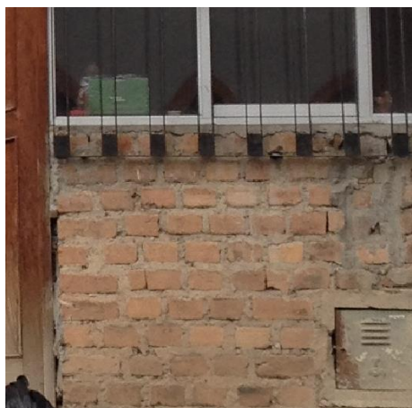
FIGURA N° 6.5 Calidad del ladrillo deficiente
