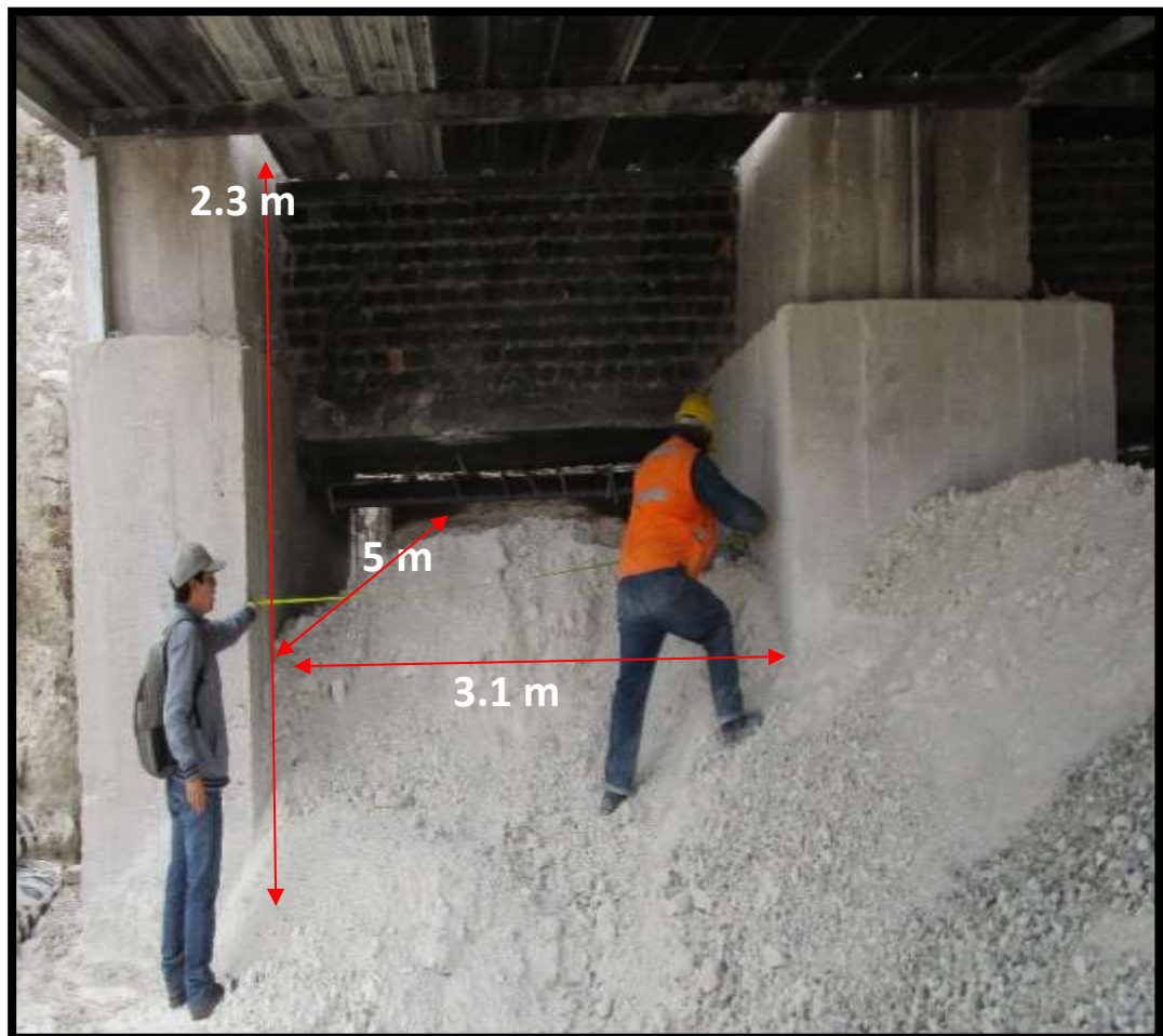
Foto 7: Medidas del Cajón del horno 1 y 2.
