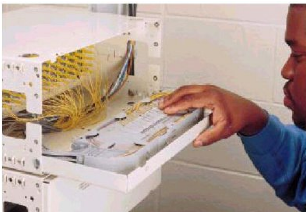
Figura 4: Panel de distribución
