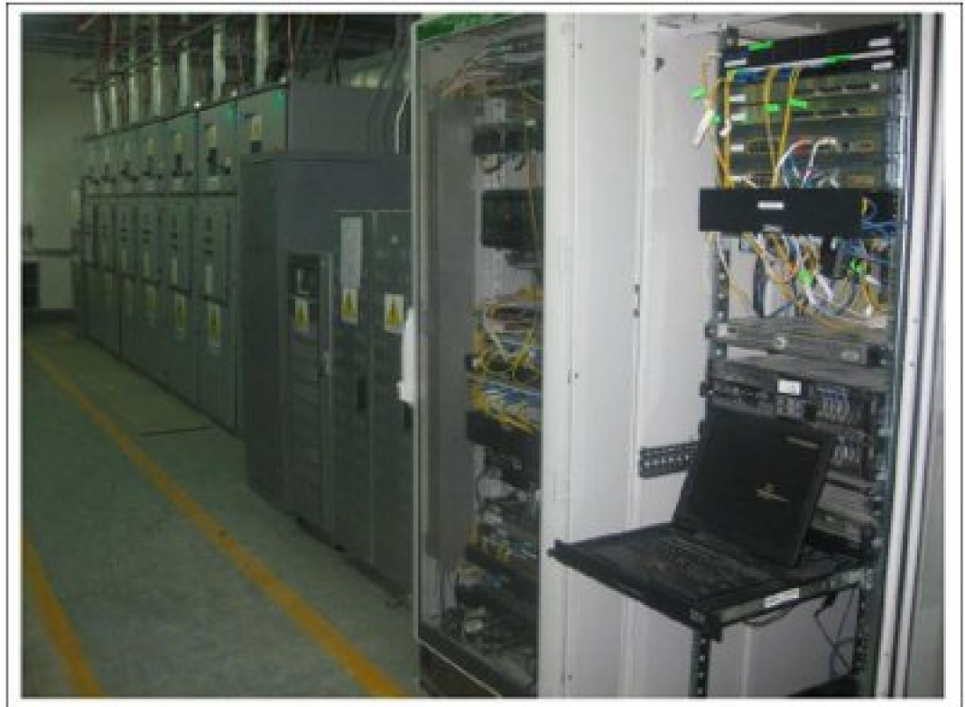
Figura 10: Sub Estación Eléctrica – Pampa Larga
