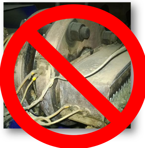
Figura n.º 36. Eliminar proceso inapropiado
