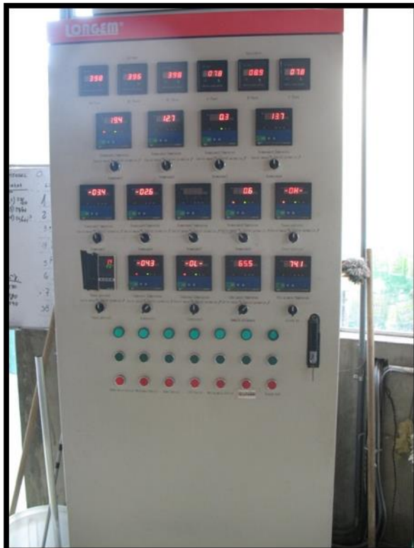
Foto N o 6: Panel de control Automático
