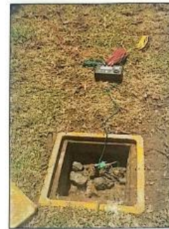
Medida del Pozo a Tierra
