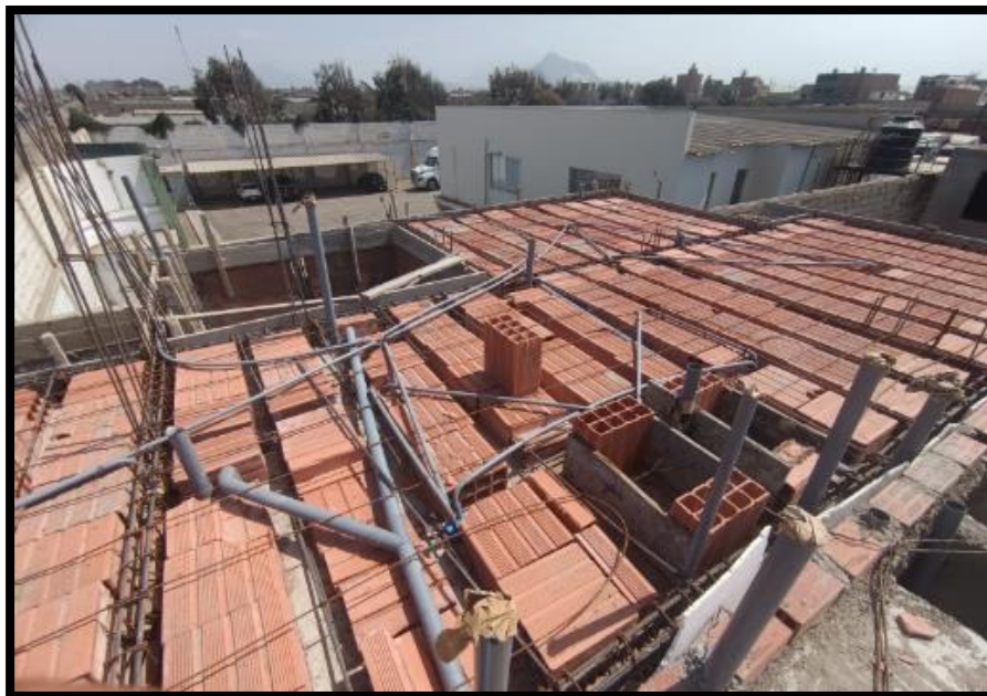
Sector 4, actividad 1 (armado de desagüe pluvial) y actividad 2 (tendido de tubería de luz para techo del segundo piso )
