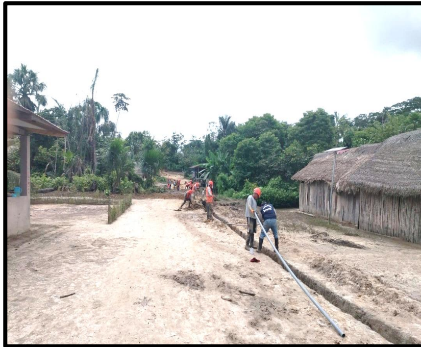
ANEXO 24. Imagen donde se visualiza las instalaciones de tubería en red de distribución.
