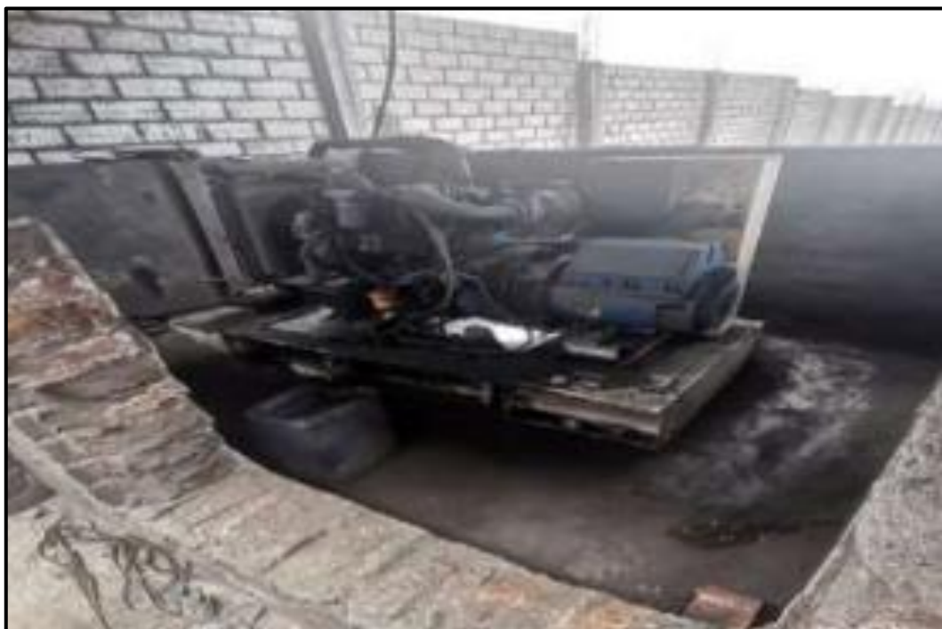
Figura N°39 Cuarto de máquinas
