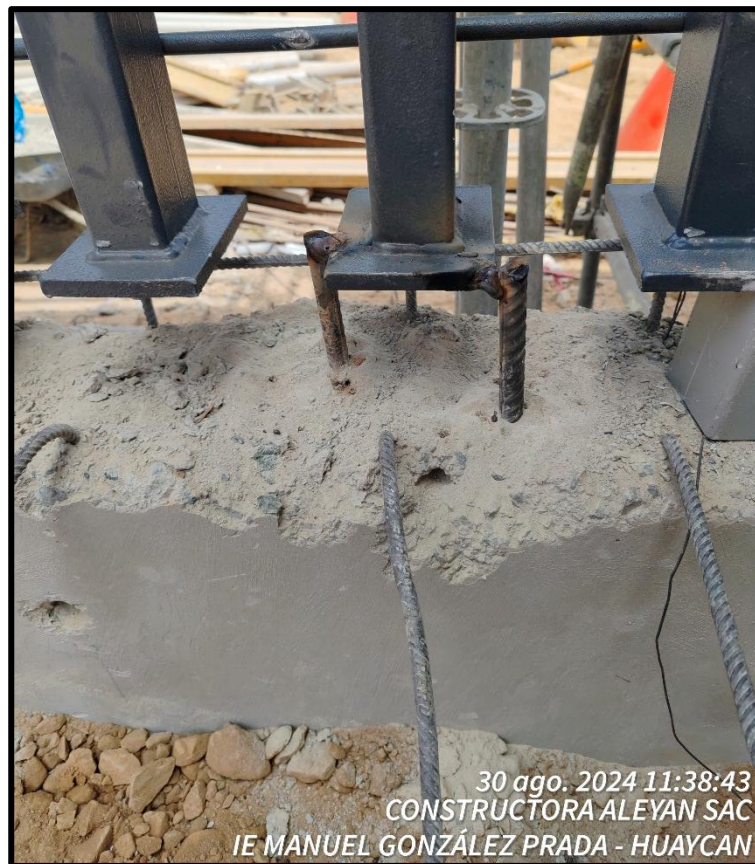
Figura N°20 Anclaje cerco metálico TIPO 1.
