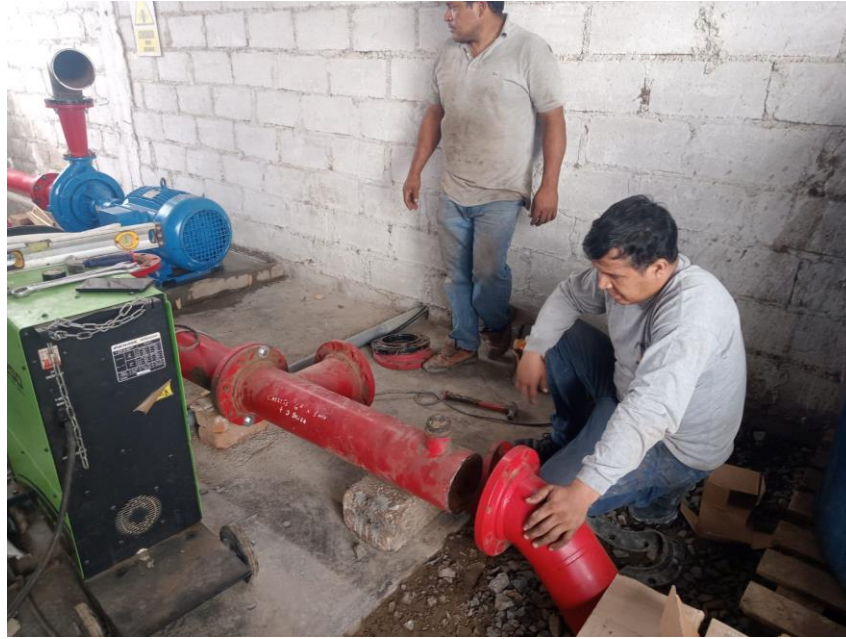
Malas practicas de trabajo y falta de EPPs
