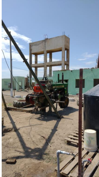
Equipo de maquinaria pesada sin señalización de zona
