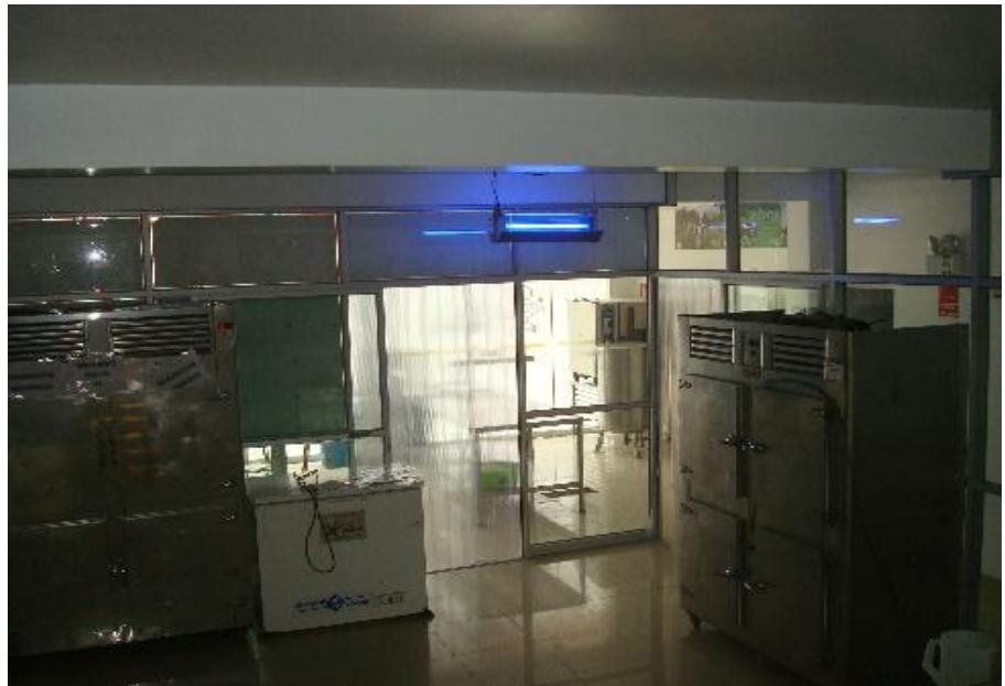
Figura N° 8 Cámaras de refrigeración de Enrique Mariscal
