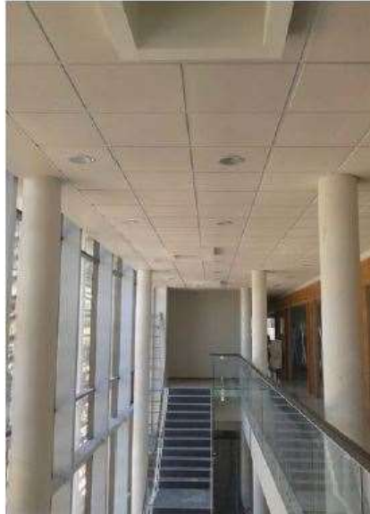
Figura 4.13. Espacio atrio de triple altura para ventilación convectiva, Contraloría Regional de la Araucanía, Temuco (zona 7 St) (BGL arqts., responsable Juan Claudio López Rubke). Ventanas practicables en la parte inferior y troneras de ventilación en el techo generan el efecto convectivo.
