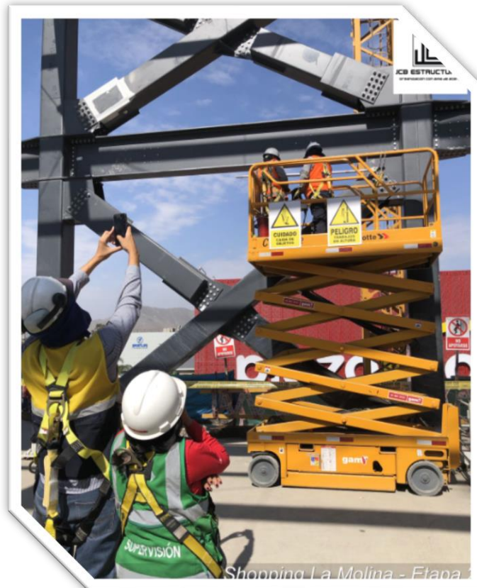
Figura 82: Proyecto Ampliación del Centro Comercial Shopping La Molina: Obra. Fuente: Elaboración propia.
