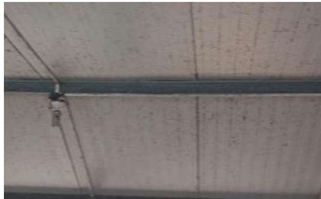
Iluminación en mal estado de servicios higiénicos
