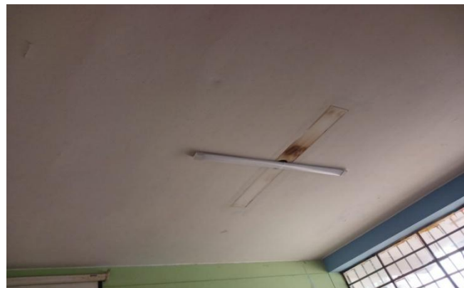
Iluminación en mal estado de aulas
