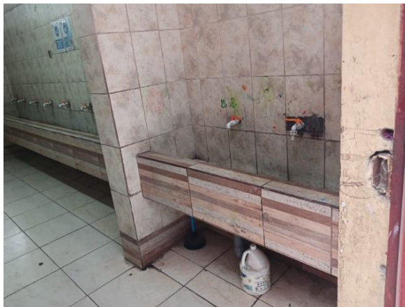
Grifos de lavaderos dentro de los baños
