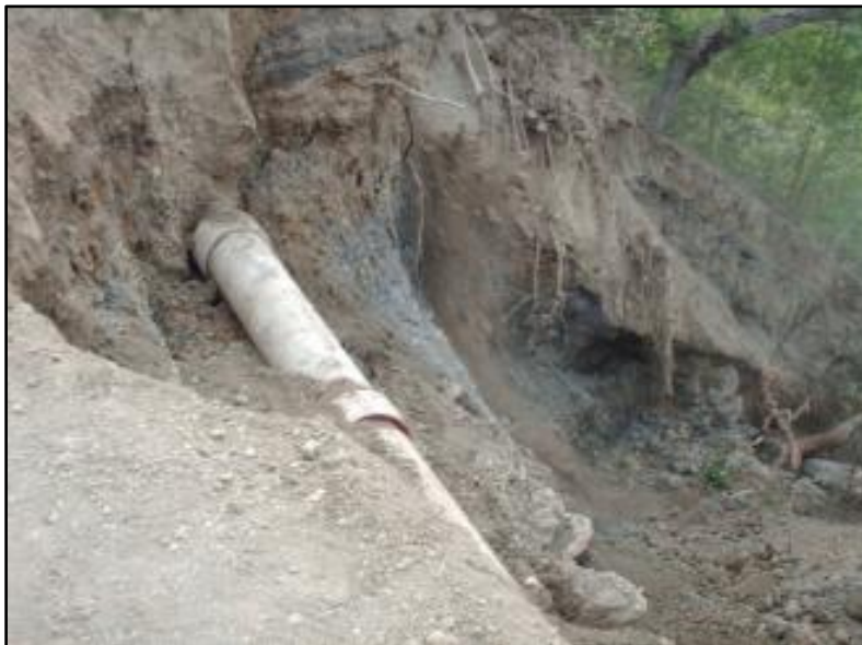
Figura 10: Línea de Conducción
