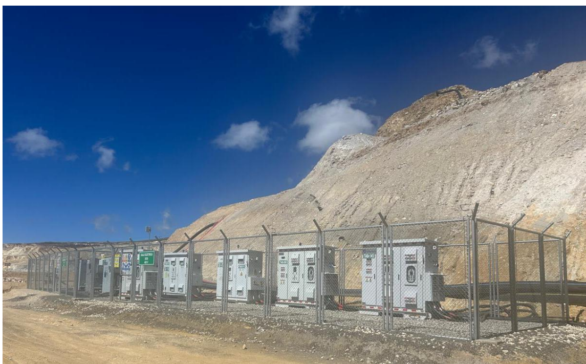
Nota. Tableros de control de bombas
