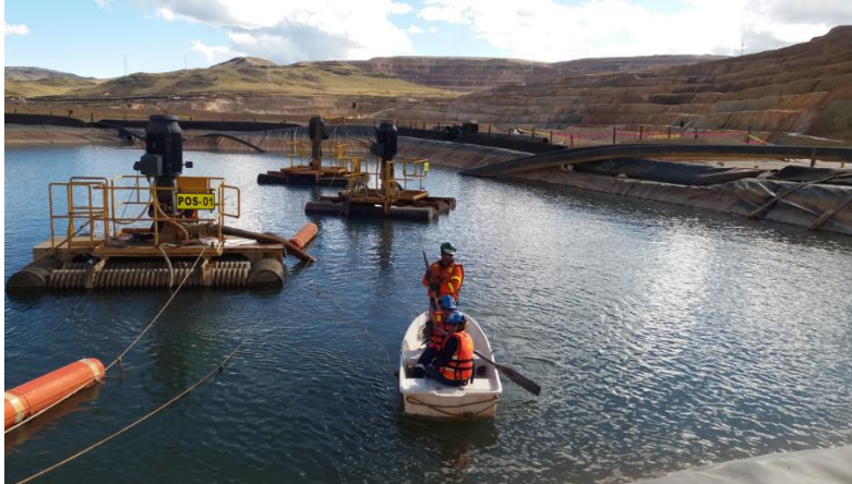
Sistema de bombeo de la unidad minera
