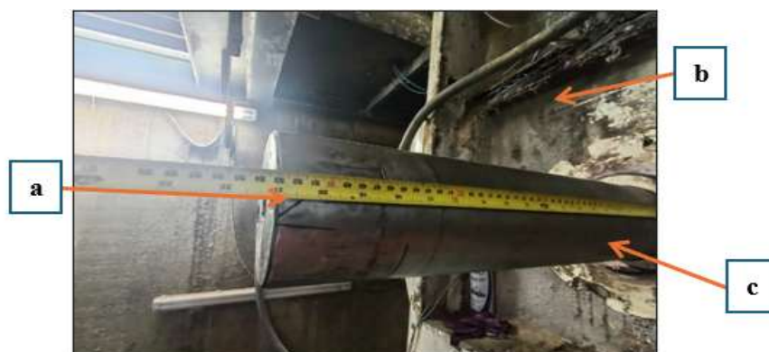
Figura 2: Eje de Mezcladora no gira, se dañó por sobrecarga y malogró al motorreductor.
