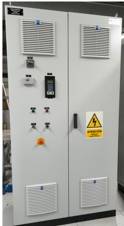
Figura 65. Nuevo tablero de arranque con variador para torre de enfriamiento.
