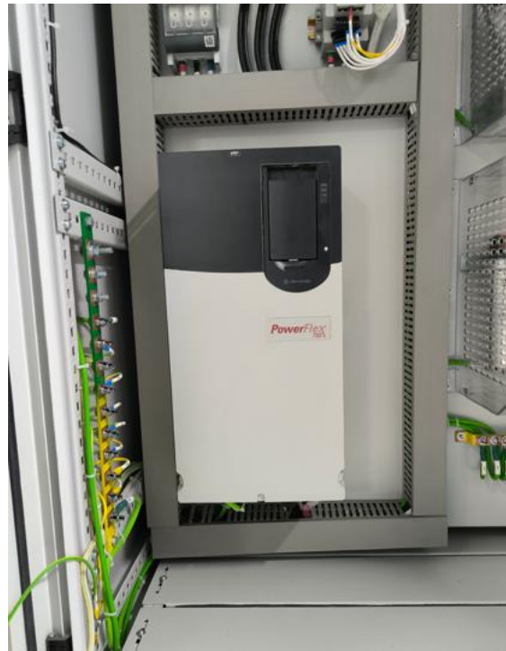
Figura 67. Variador de velocidad PowerFlex 755.
