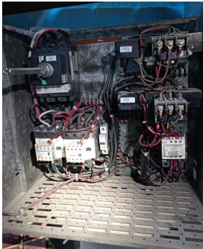
Figura 64. Antiguo cubículo de arranque para torre de enfriamiento.
