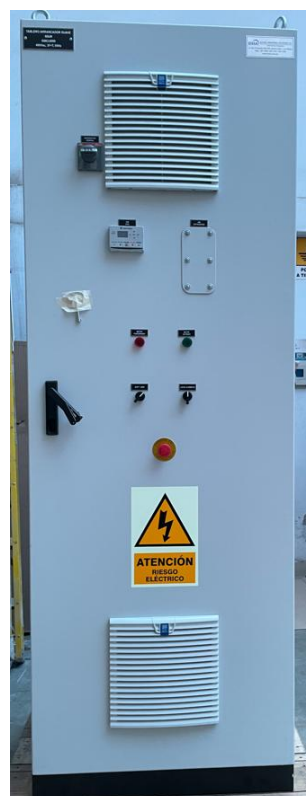
Figura 66. Nuevo tablero de arranque con Soft starter para bomba de recirculación de torre de enfriamiento.
