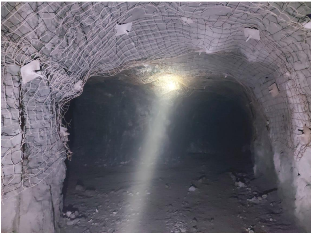
Figura 11. Daños estructurales en el contorno de la labor
