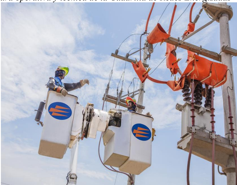
Figura 37 Estructura operativa y técnica de la Cuadrilla de Redes Energizadas
