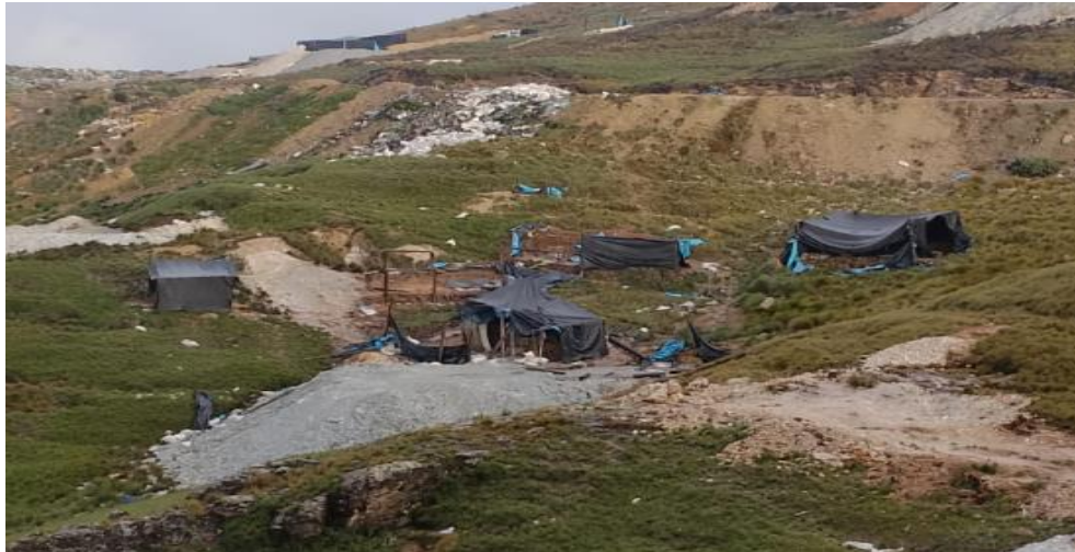
Labores al borde del precipicio y/o carretera
