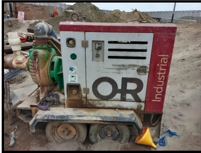
Figura 3.4 Máquina de bombeo
