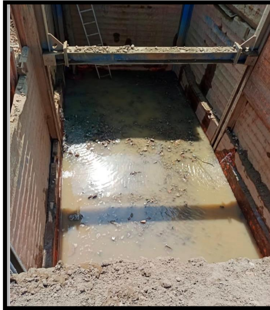
Figura 3.9 Inundación de la excavación
