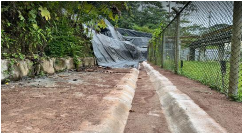
Drenaje Perimetral Sur
