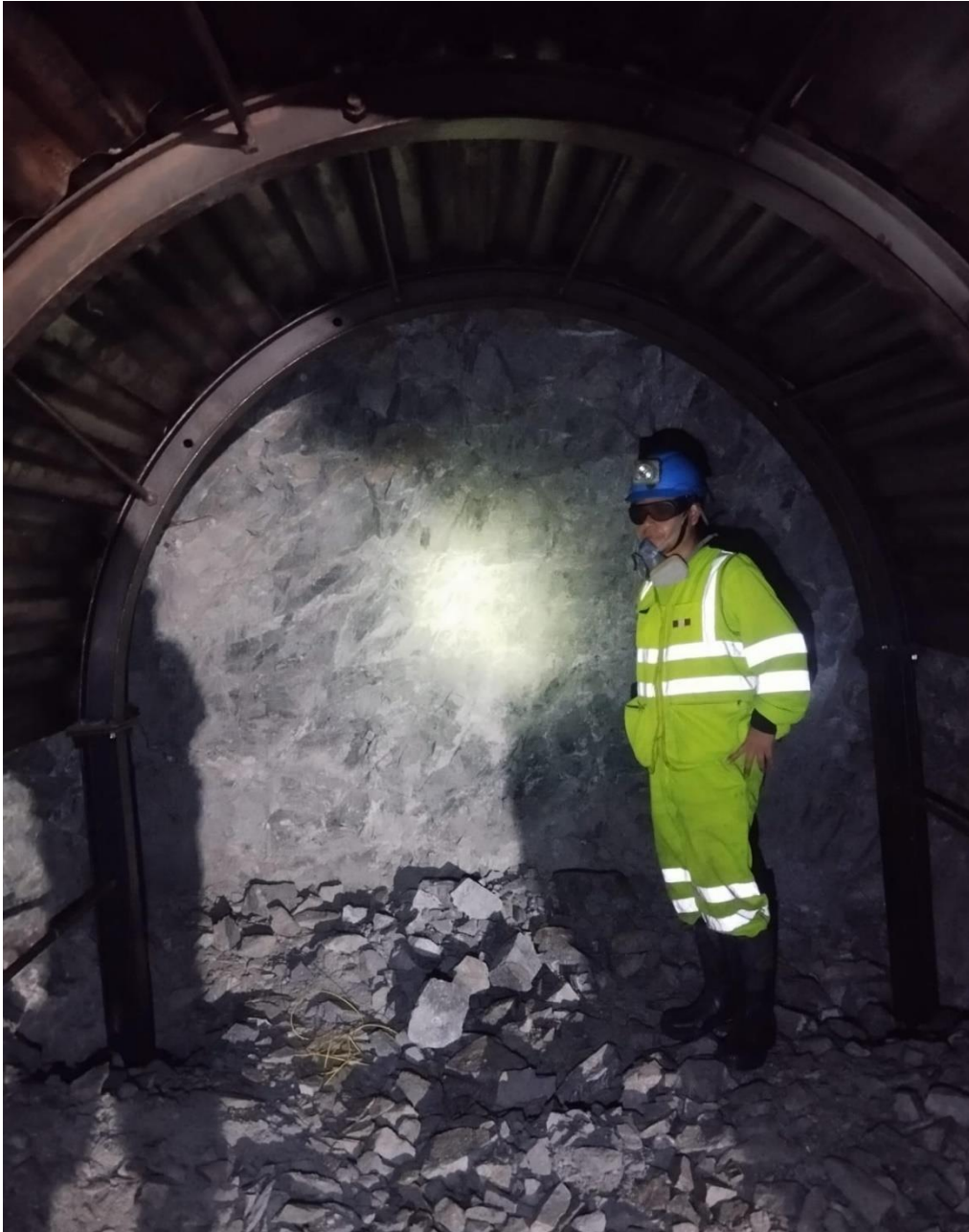
Frente de la labor de avance BP 2573 con elemento de sostenimiento pasivo con arco de acero – cimbras
