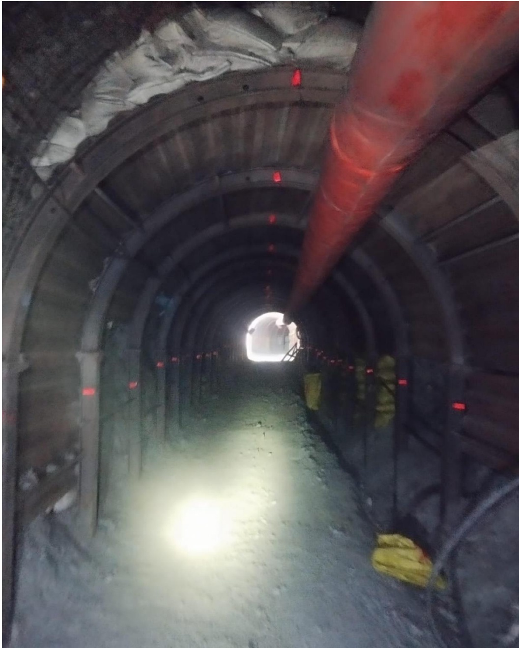
Sistema de ventilación para la labor de avance BP2573
