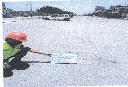
Hundimiento del pavimento
