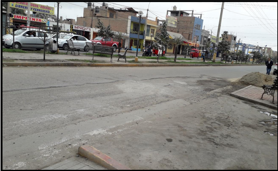
Figura 23. Agrietamiento y fisura en la avenida Víctor Andrés Belaunde.
