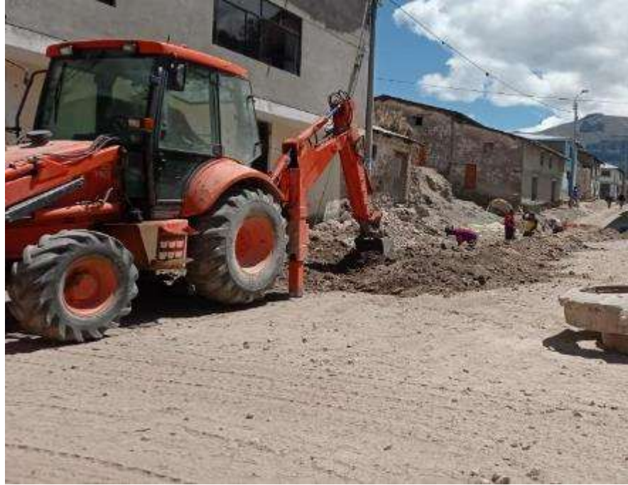
Figura 29 Excavación de zanja con maquinaria para instalación de tuberías en el Jr. Revolución
