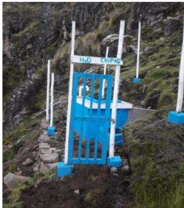
Figura 5 Captación Saccsihua tipo manantial en ladera
