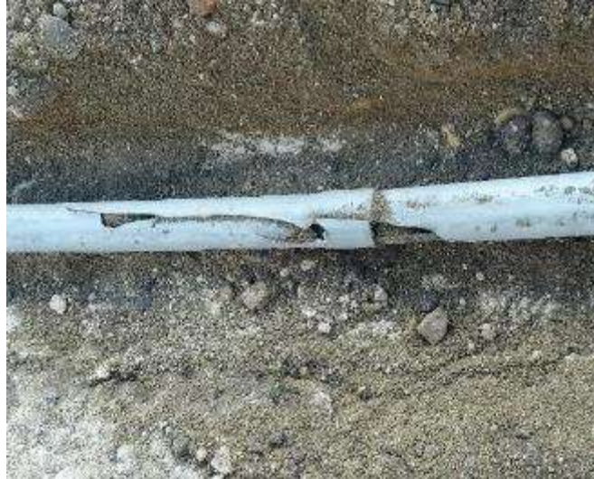
Figura 14 Tuberías de la red distribución colapsadas por estar enterradas superficialmente
