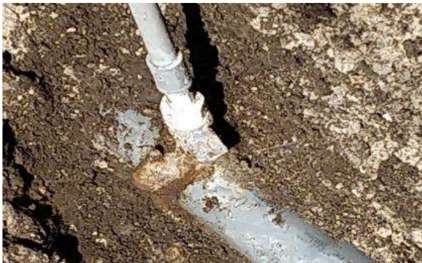
Figura 15 Abrazaderas de F•F• en conexiones domiciliarias
