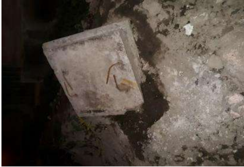
Figura 16 Estado de una caja y tapa de una válvula de control, totalmente colmatadas
