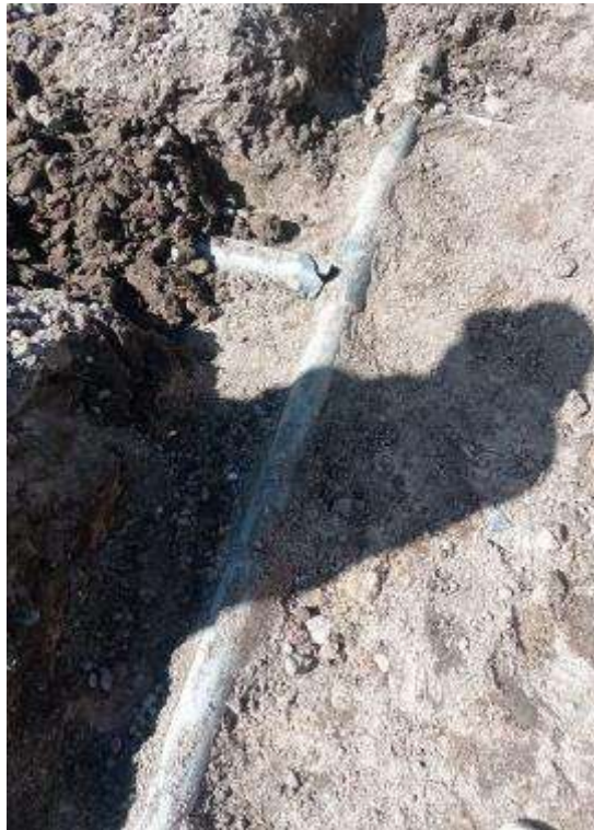
Figura 27 Tubería y accesorio por ser reemplazada
