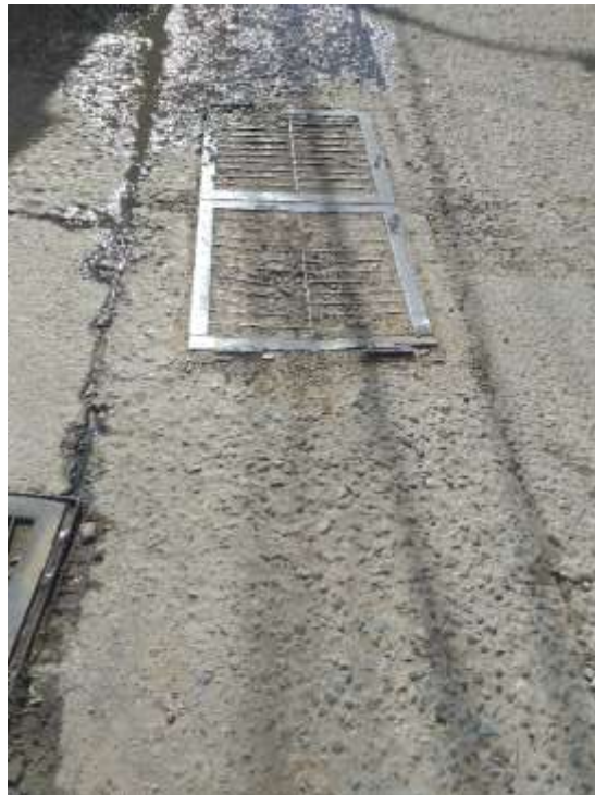
Ilustración 2: Intersección entre la avenida San Martín de Porres y Mision japonesa, colectores totalmente saturados con sedimentos
