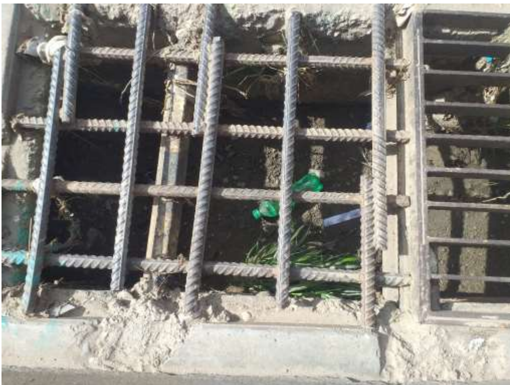
Ilustración 3: Avenida San Martín de Porres Cuadra 10, colectores totalmente saturados con sedimentos y botellas plásticas
