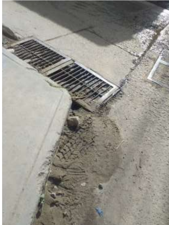
Ilustración 1: Av. San Martín de Porres cuadra 9, colectores totalmente saturados con sedimentos
