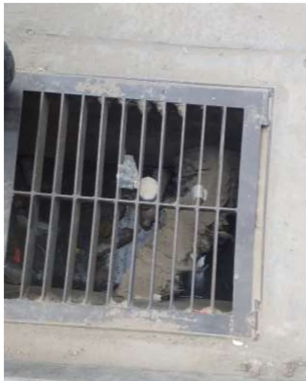
Ilustración 8: Avenida San Martín de Porres cuadra, tubería instalada de forma transversal dentro del colector; obstruyendo el pase
