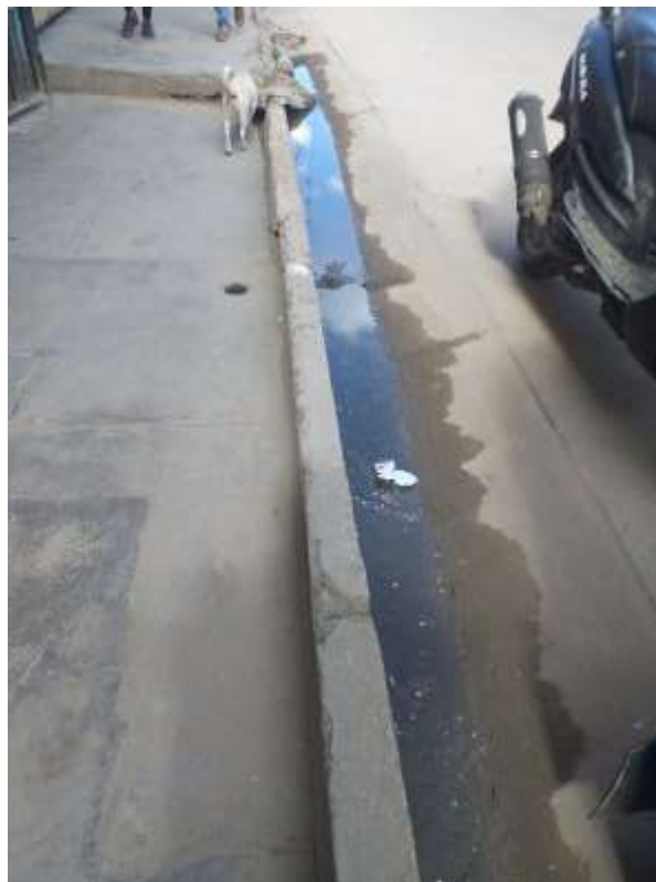
Ilustración 6: Avenida San Martín de Porres cuadra 9, obstrucción de los colectores de evacuación con rampa de ingreso para vehículos.
