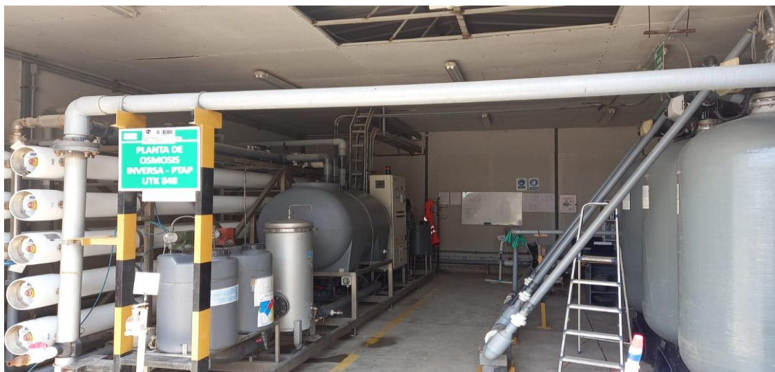
Planta de tratamiento de agua N° 1
