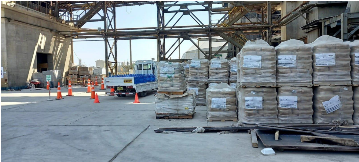
Materiales para mantenimiento refractario de Horno
