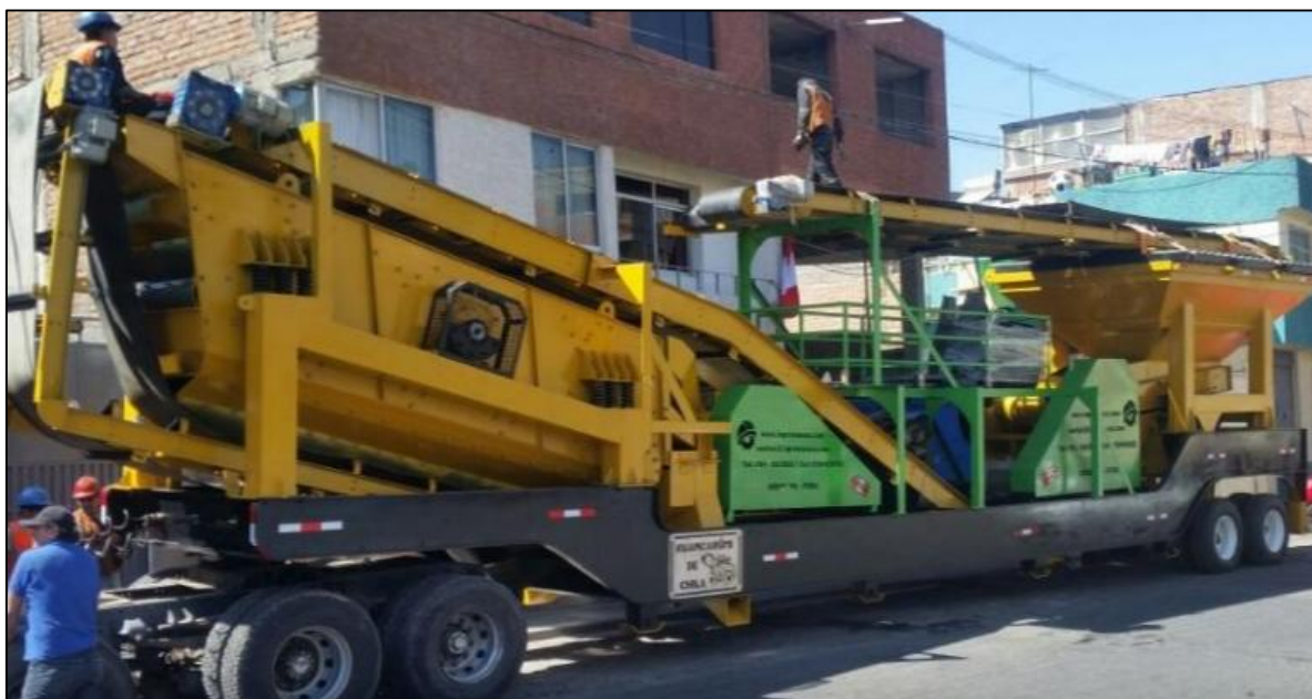
Foto 21: Equipos para la planta chancadora a instalar.
