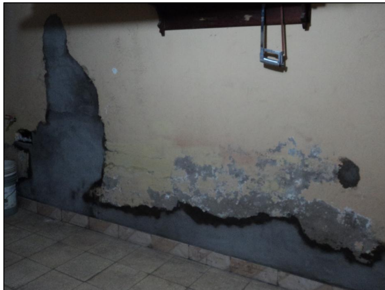
Gráfico n.º 23. Eflorescencia en muro de primer nivel. (Fuente: Propio)
