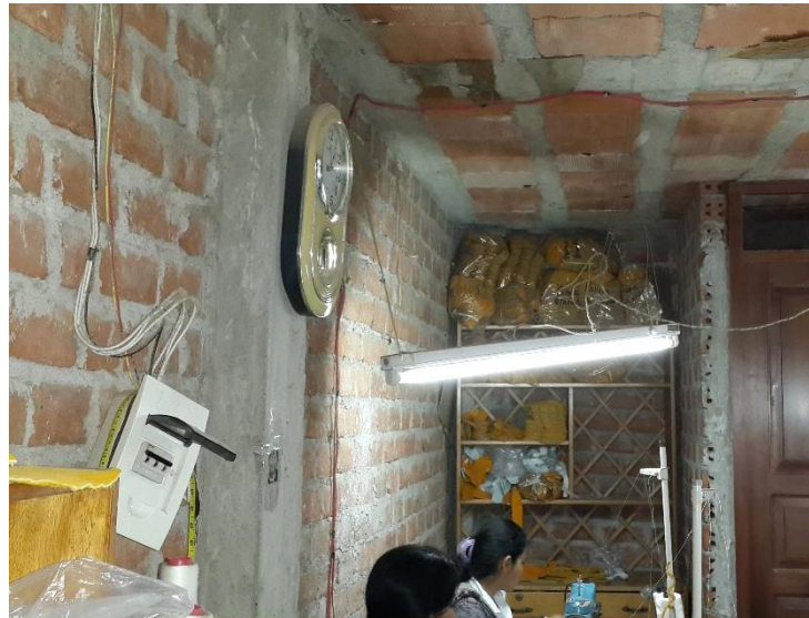
IMAGEN N°07: Sistema Eléctrico Confección N°02
