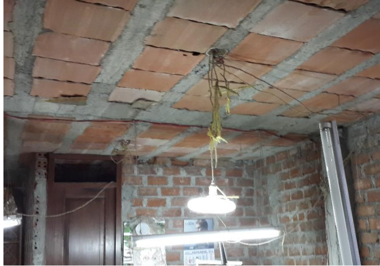
IMAGEN N°06: Sistema Eléctrico Confección N°01
