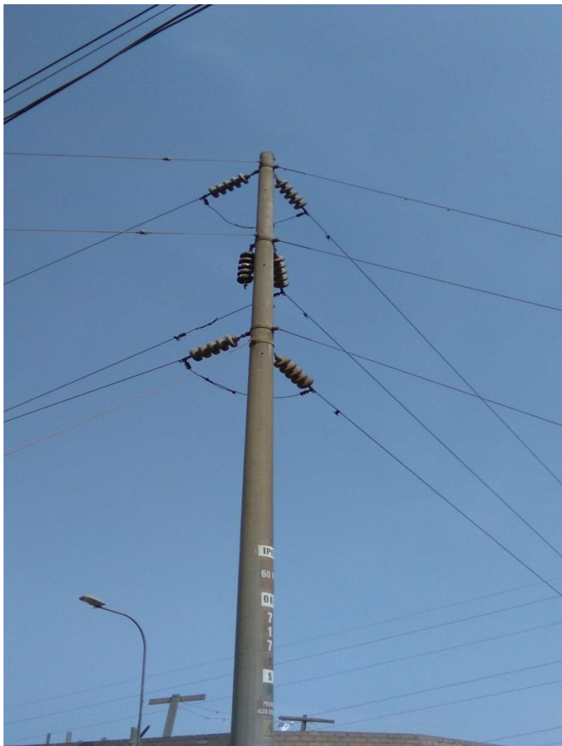
Figura n.º 3-6 Rotura de grapa de anclaje fase S en la estructura N°6 de la L.717.
