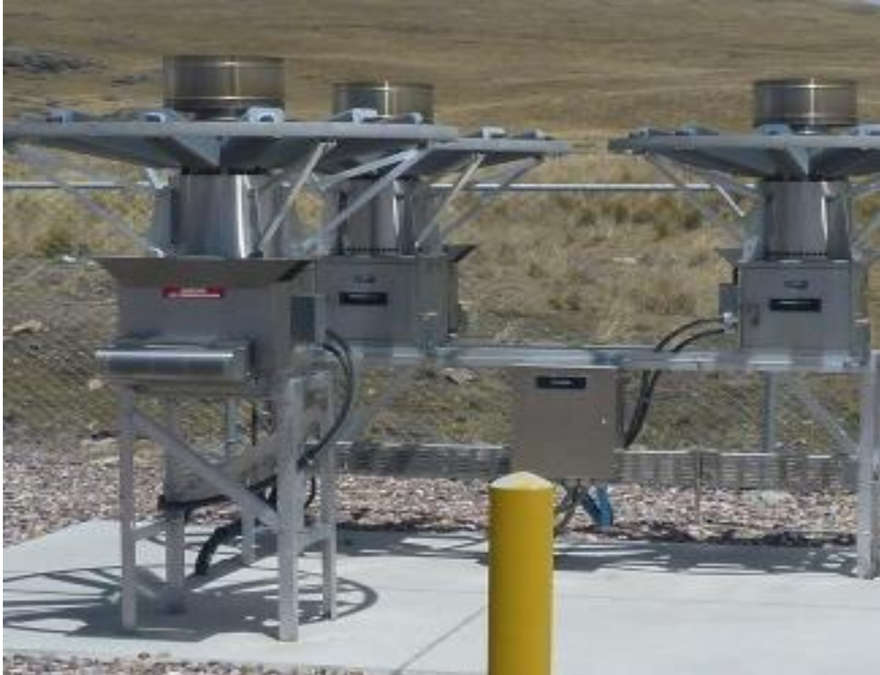
Figura 30: Foto de los termogeneradores con resistencias instaladas
