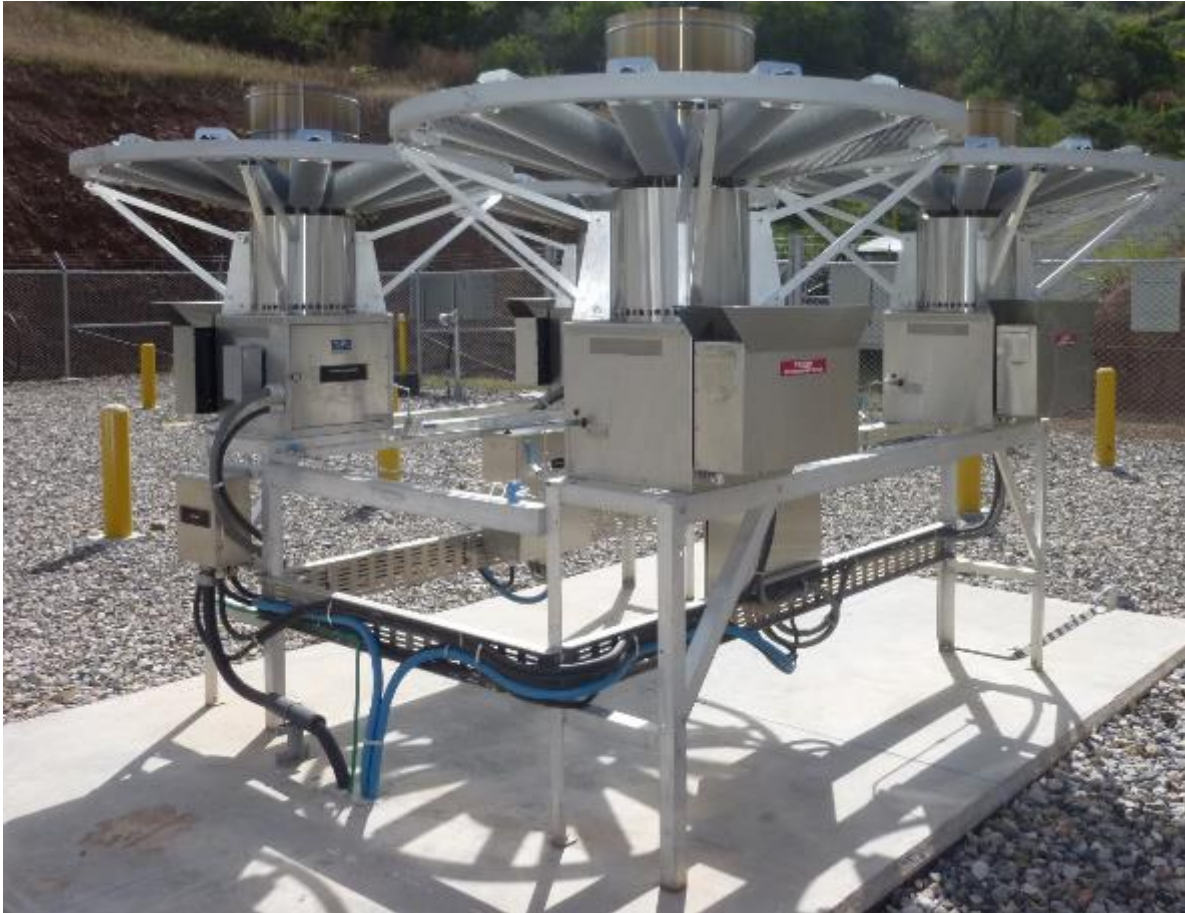
Figura 29: Foto de los termogeneradores sin resistencias instaladas
