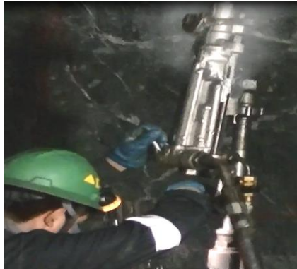
Fig. N° 14: Apertura de la válvula del aire para comprobar la máquina en vacío
