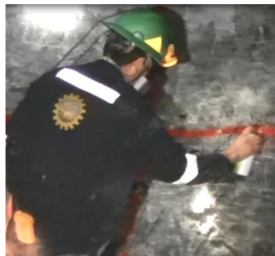
Fig. N° 15: Marcado de la malla de perforación de acuerdo al tipo de roca
