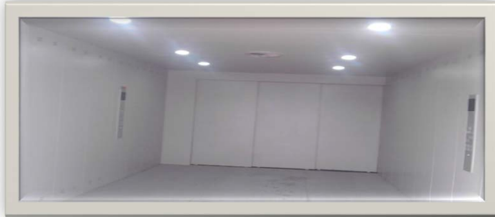
Figura 8: Ascensor para autos del CC. Plaza Toros.
