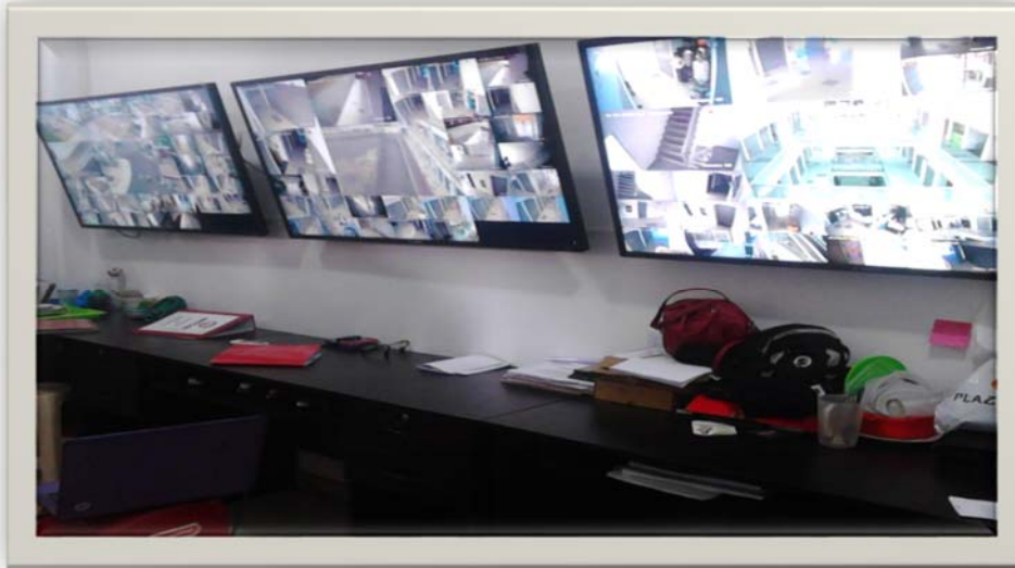
Figura 7: Cámaras de Seguridad del CC. Plaza Toros.
