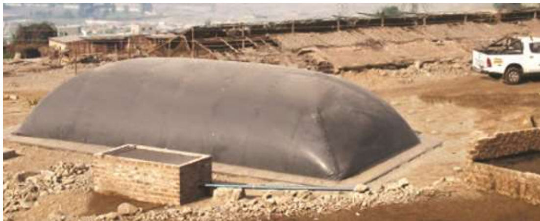
Figura N° 6. Digestor Modelo laguna cubierta.
