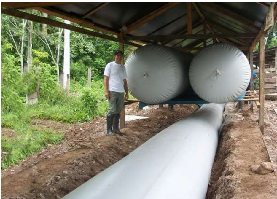
Figura N° 7. Biodigestor Modelo Tubular instalado en la localidad de Tocache – San Martín – Perú. Consta de 02 gasómetros.
