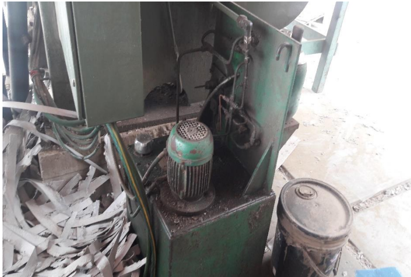
Figura 9: Falta orden y limpieza
