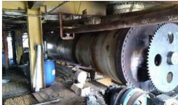
Figura 14. Digestor – Línea de Digestión
