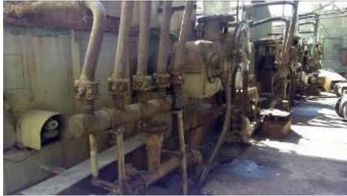
Figura 15. Lavadoras – Línea de Lavado
