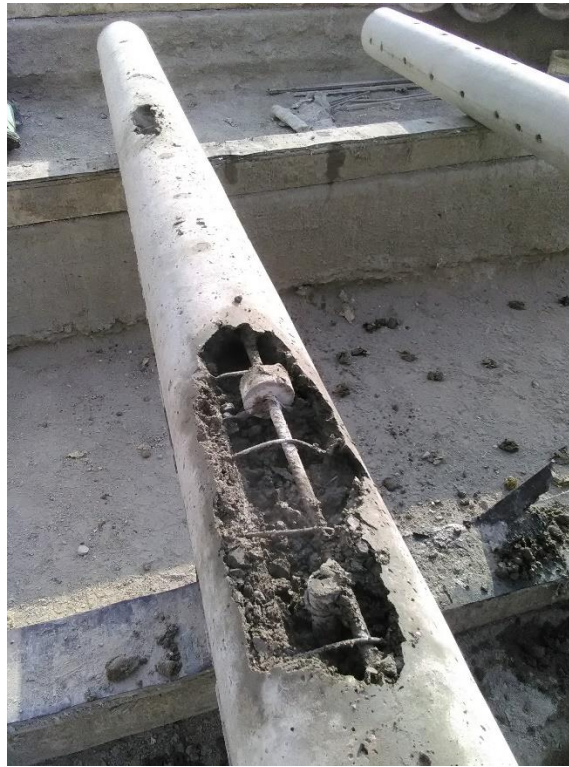
Figura n.º 6: Poste con cangrejas
