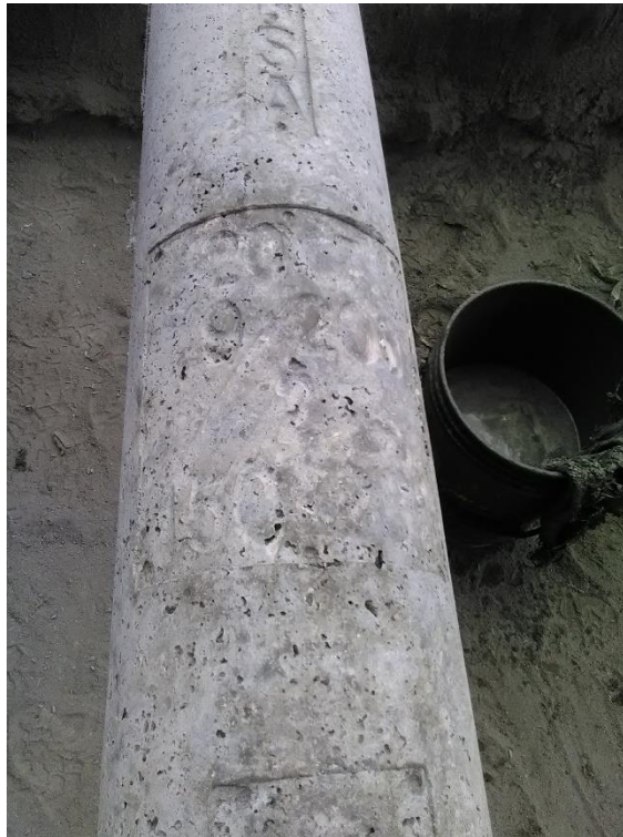
Figura n.º 7: Poste con porosidad a lo largo de todo el poste
