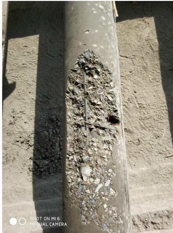
Figura n.º 8: Poste con mezcla desprendida por mala calidad de agregado
