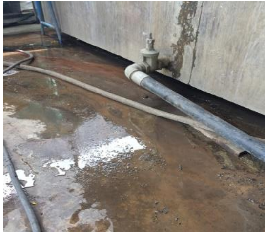
Figura 14 Conexión de agua al proceso de lavado - CUC S.A.C.
