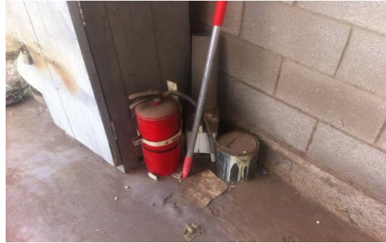
Figura 59 Extintor obsoleto en el área de triturado de materia prima limpia
