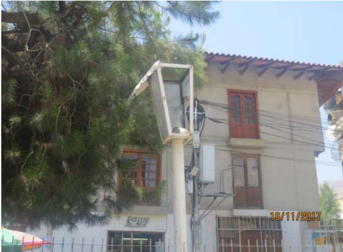
Figura 126: Iluminación destruida en Parque Las Flores
