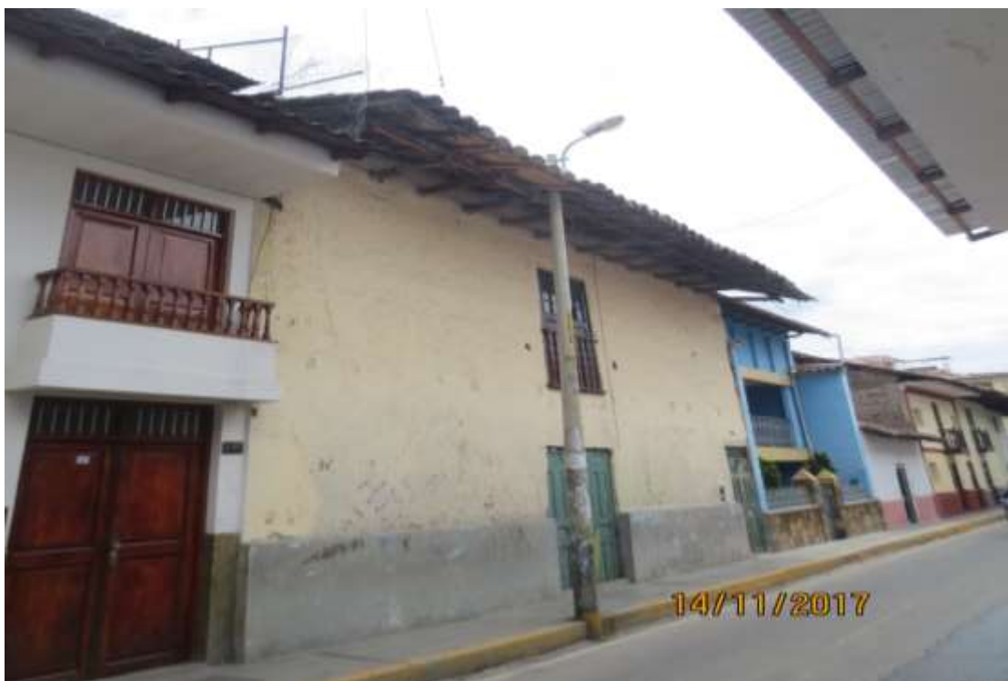
Figura 99: Posteo de luz atravesando tejado de viviendas en Jr. Amazonas
