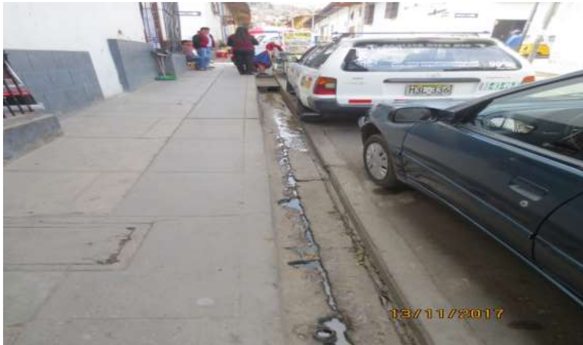
Figura 124: Cunetas en mal estado en Jr. Tarapacá
