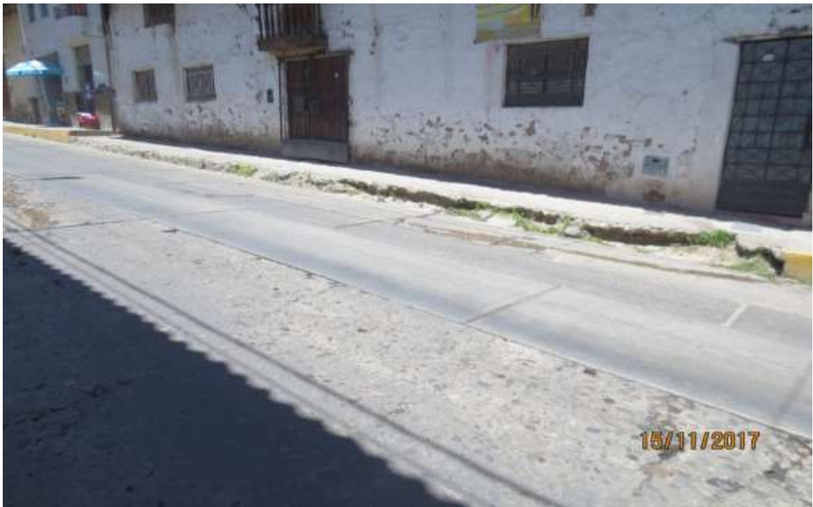
Figura 119: Vereda destruida en Jr. José Gálvez
