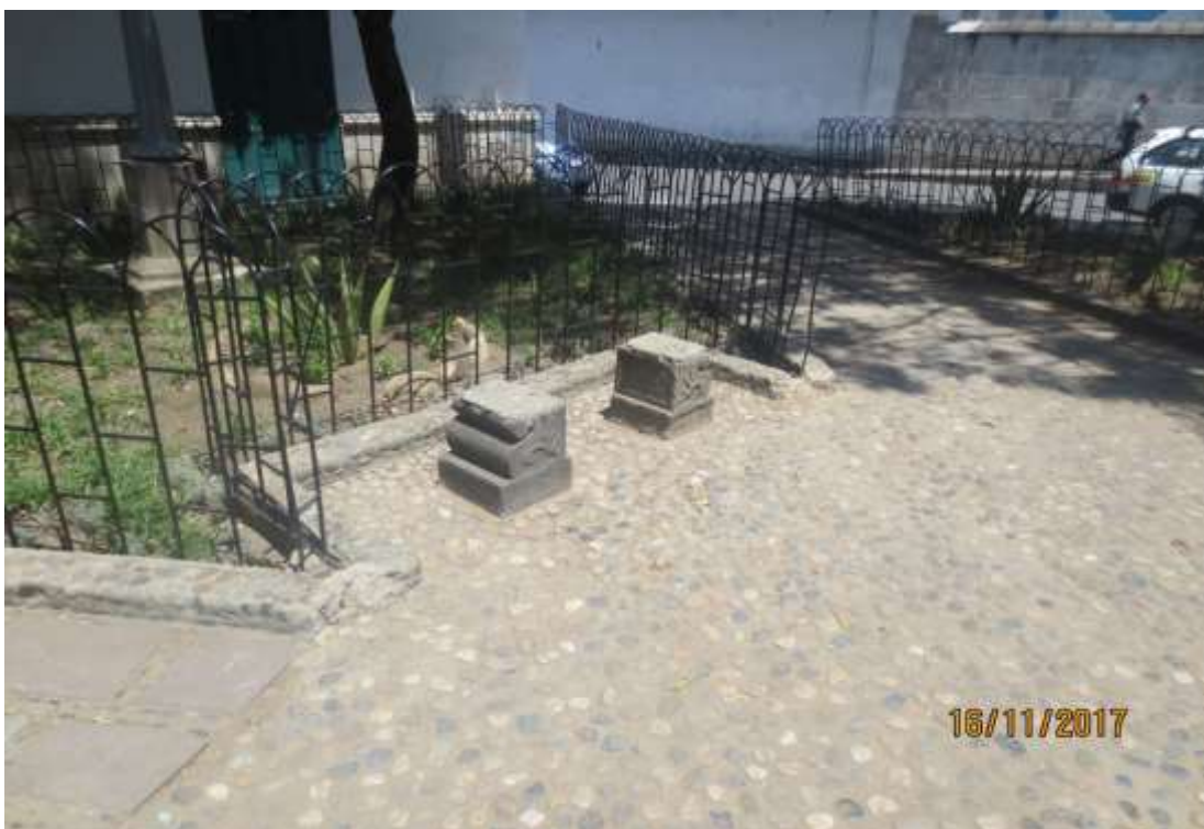
Figura 129: Bancas destruidas y piso deteriorado en plazuela Las Monjas
