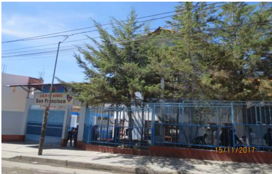
Figura 113: Cableado cercano a vegetación en Av. 13 de julio
