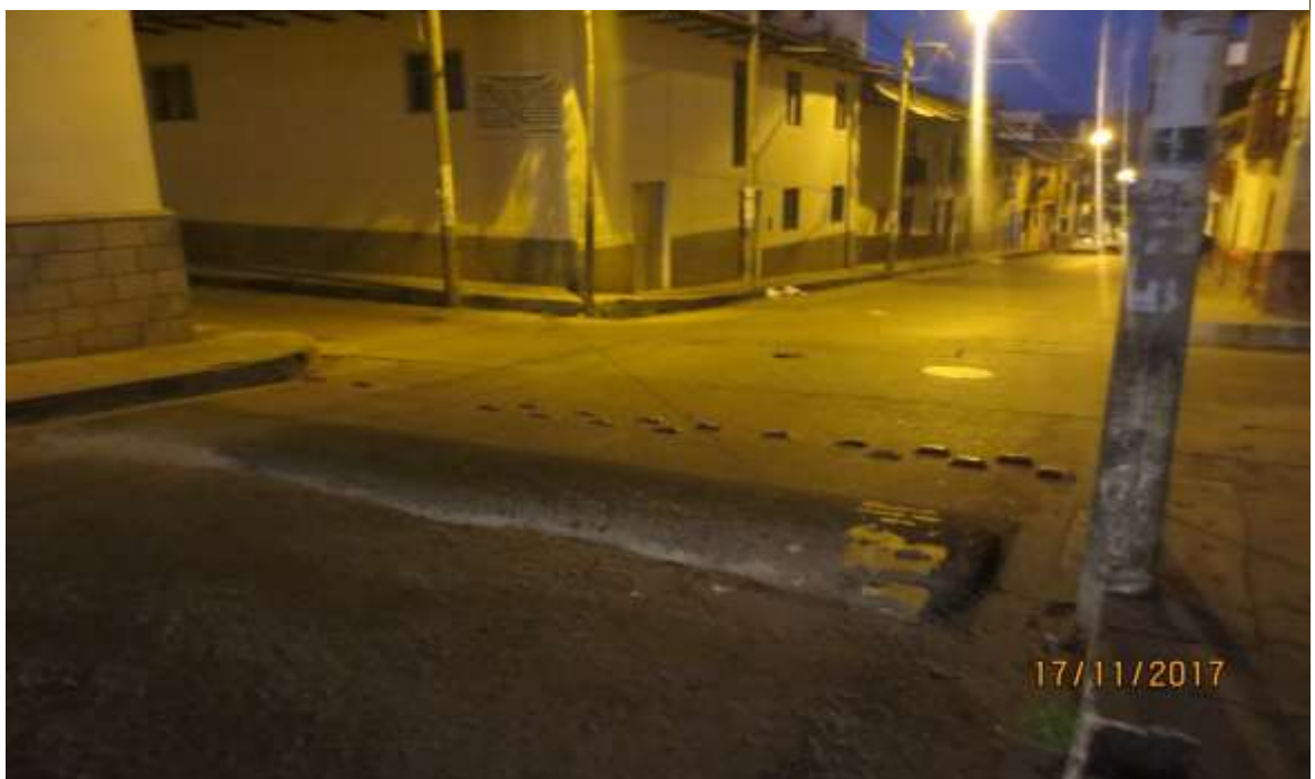
Figura 111: Reductores de velocidad dañados y pocos visibles
