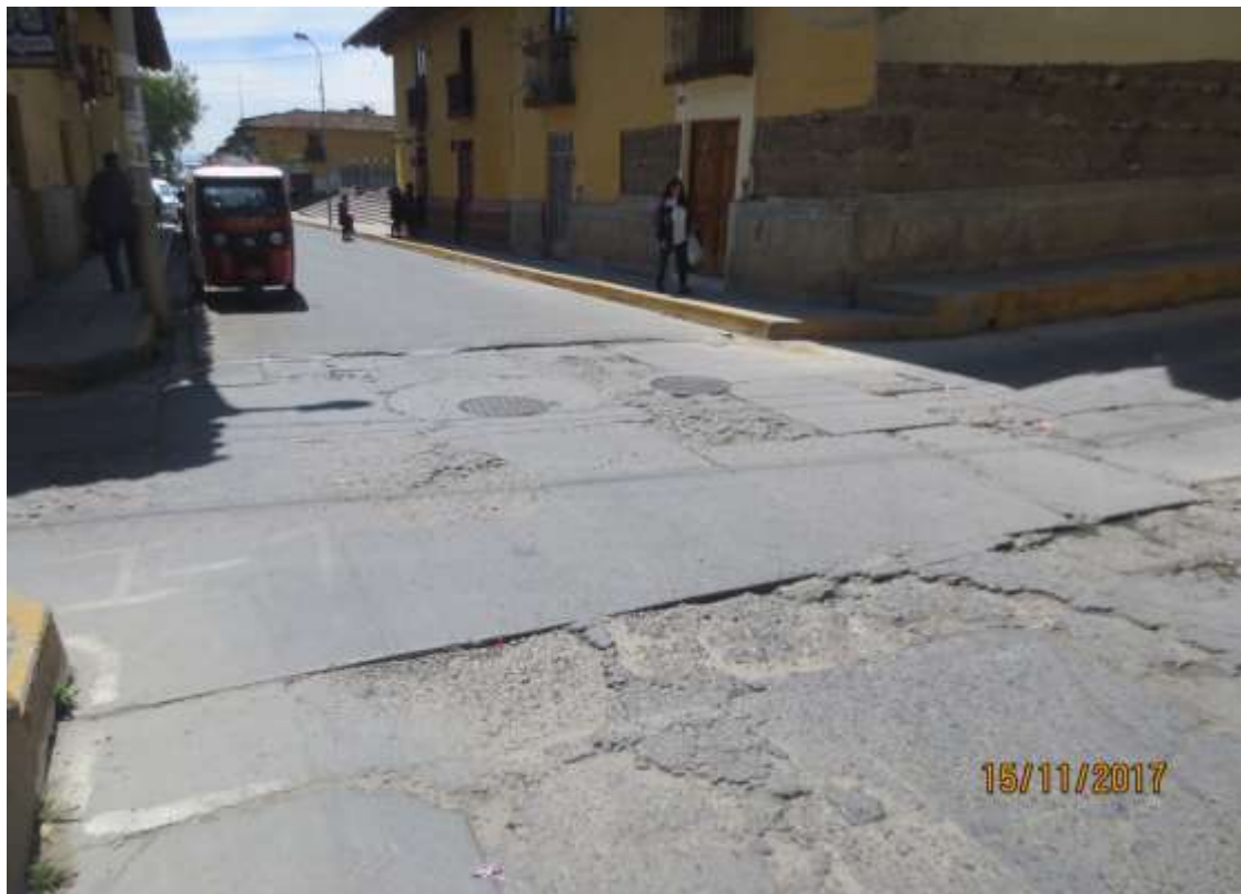
Figura 125: Calzada en mal estado en Jr. Junín
