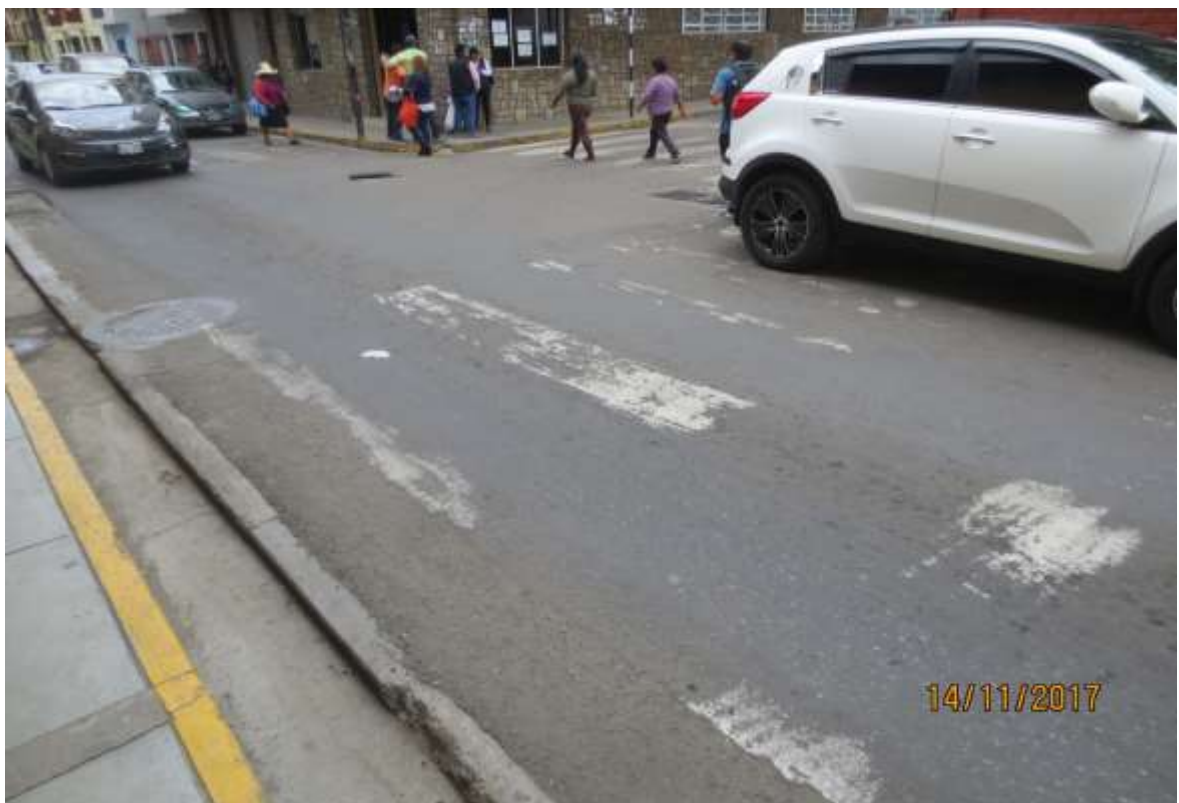
Figura 101: Calzada en buen estado pero con cruces peatonales borrosos en Jr. Amazonas
