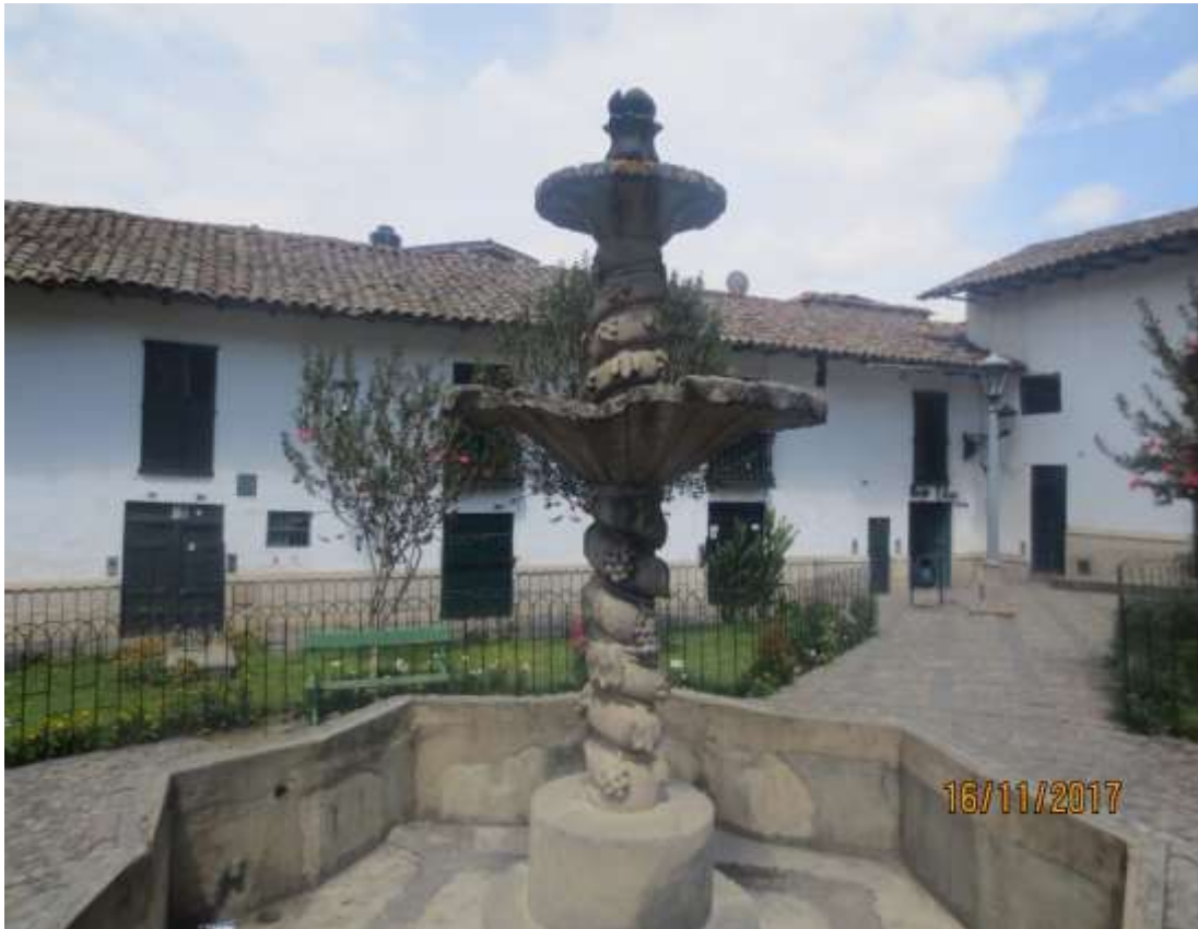
Figura 128: Pileta deteriorada en plazuela Belén
