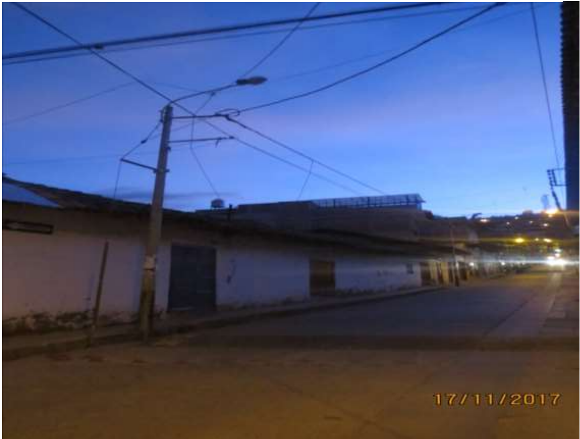
Figura 110: Poste dañado en Jr. Apurímac
