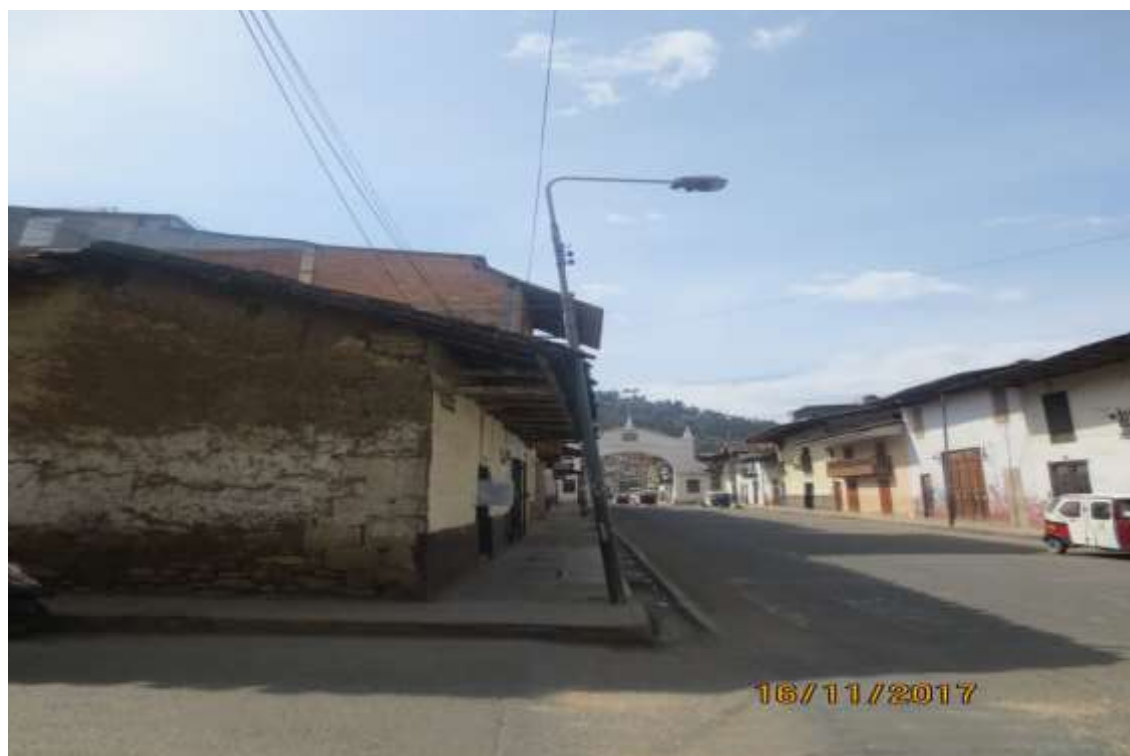
Figura 117: Poste próximo a caerse y fuera de funcionamiento en Jr. Del Comercio
