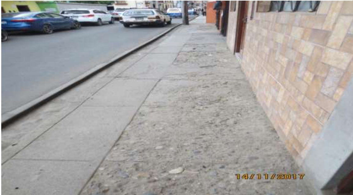
Figura 96: Vereda deteriorada en Jr. Amalia Puga
