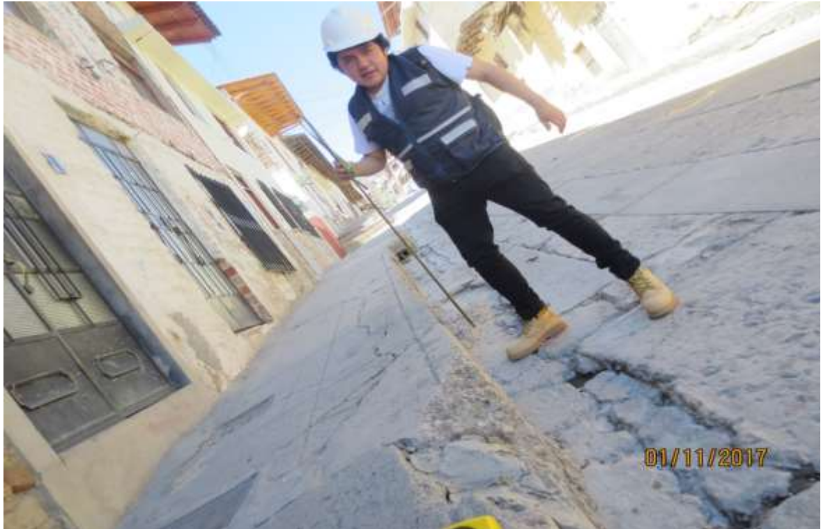
Figura 114: Vereda y calzada en mal estado en Jr. Cruz de Piedra
