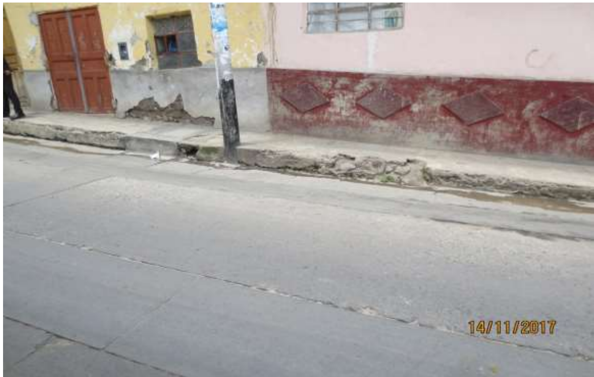
Figura 103: Veredas dañadas en Jr. A. G. Urrelo
